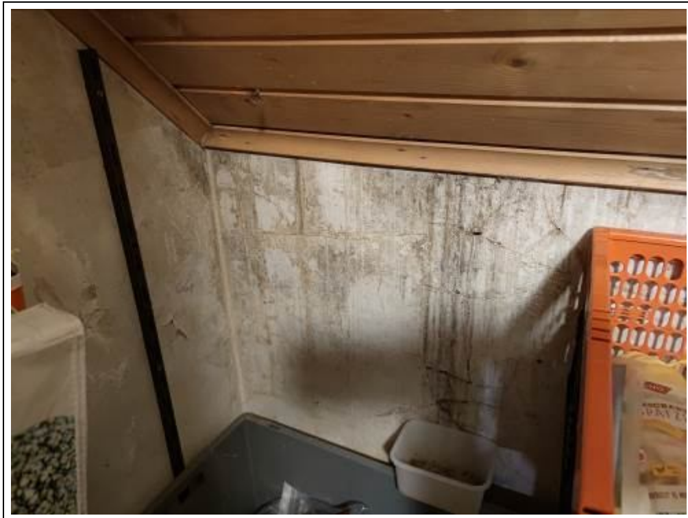
Blick auf Feuchtigkeitsschäden an der Außenwand in der Speis
