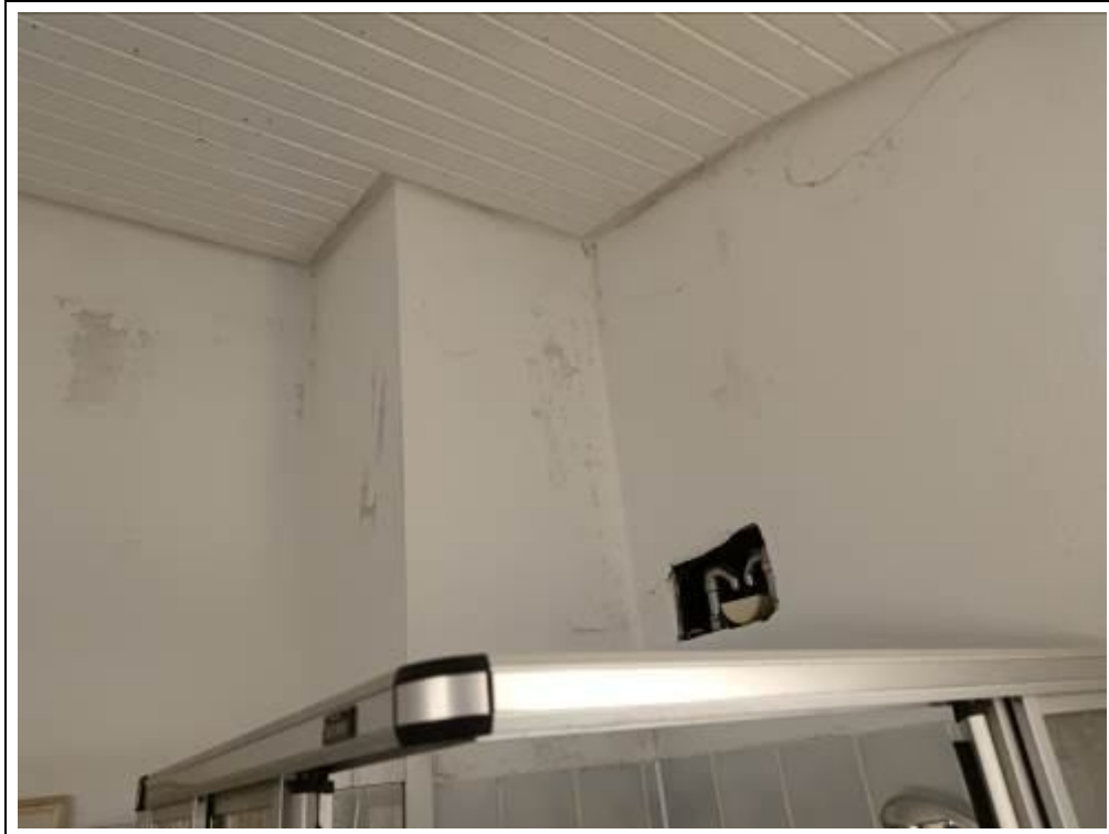
Blick auf Feuchtigkeitsschäden im Bad 1
