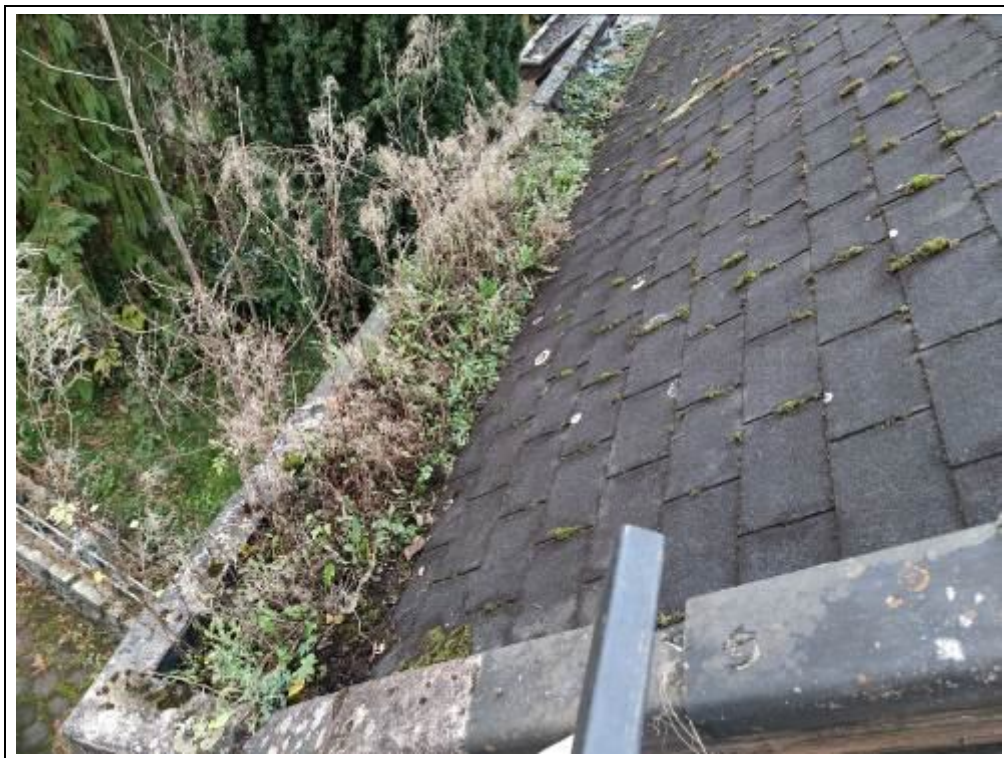
Blick auf zugesetzte Regenrinne
