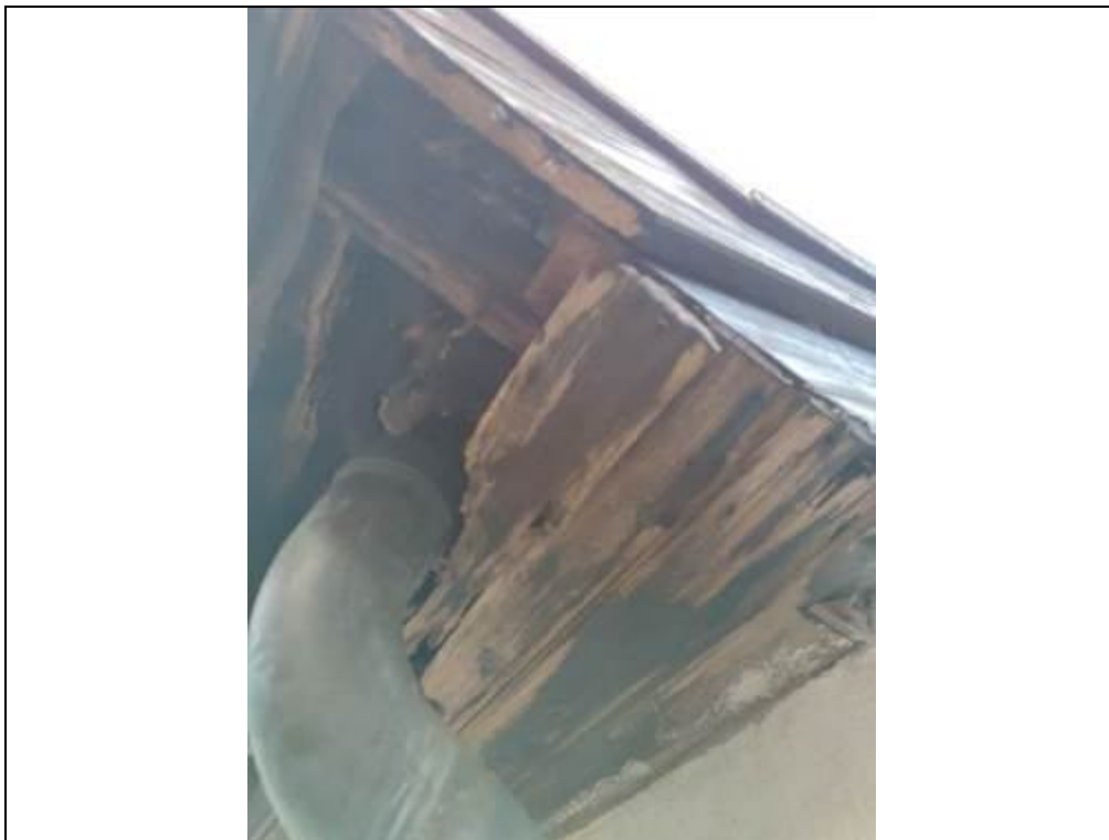
Blick auf Schäden an der Ortgangsuntersicht im Bereich des Regenfallrohrs
