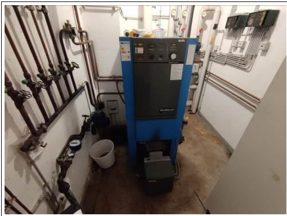
Blick auf die Heizungsanlage
