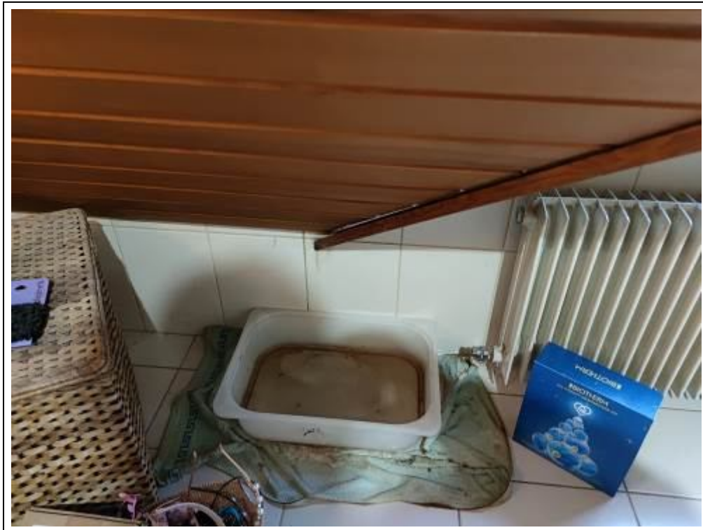
Blick auf Feuchtigkeitsschäden im Bad 2 im Dachgeschoss (Wasser läuft durch die Dachschräge)
