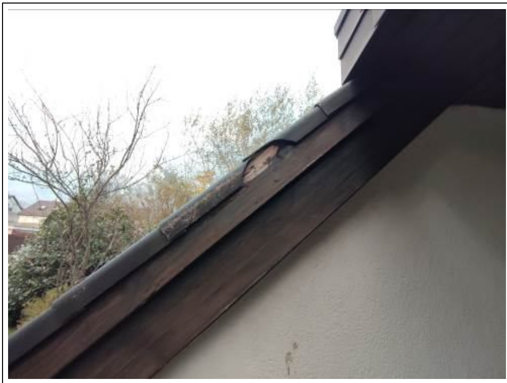
Blick auf Schäden an der Ortgangsverkleidung
