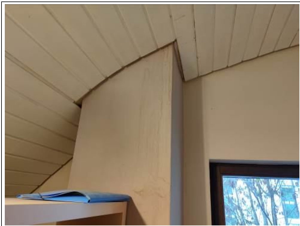
Blick auf Feuchtigkeitsschäden am Kamin
