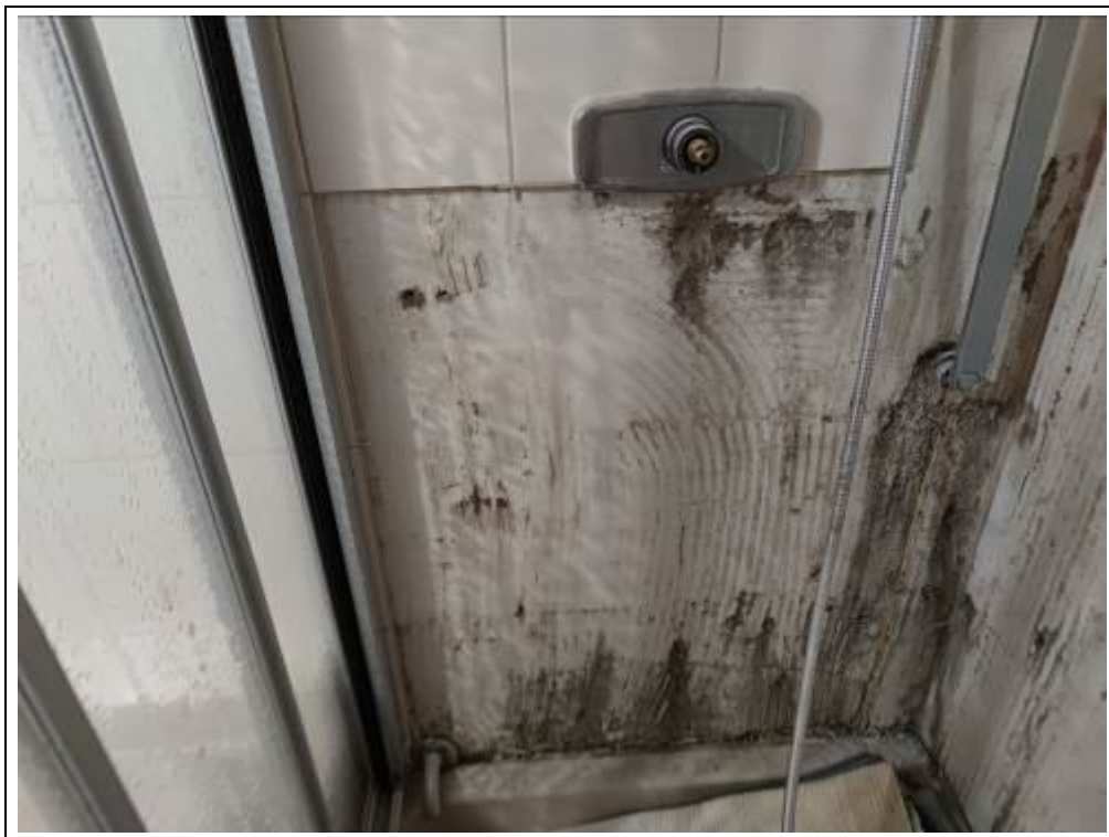
Blick in extreme Feuchtigkeitsschäden und abgefallene Fliesen in der Dusche im Bad 2
