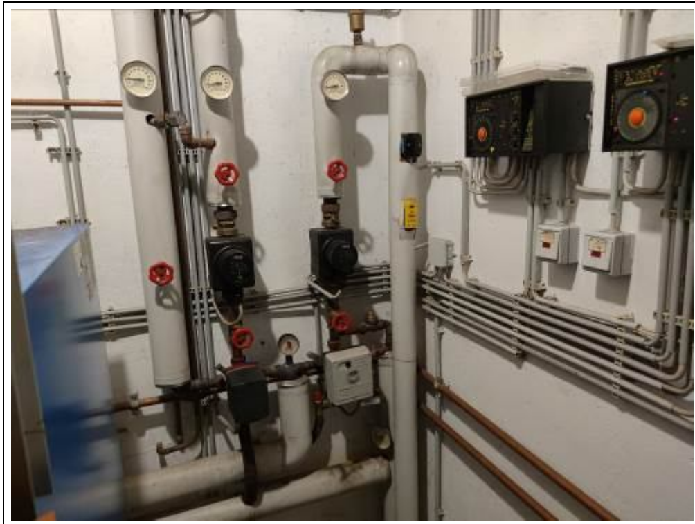
Blick auf die Heizungsleitungen
