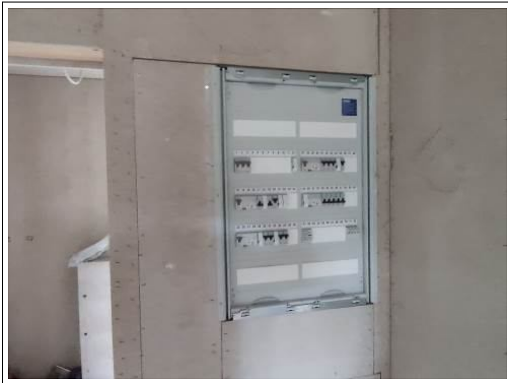
Blick auf die Elektrounterverteilung im Erdgeschoss
