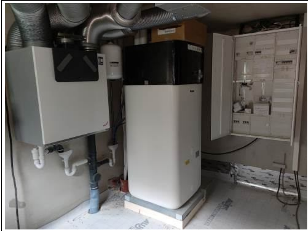
Blick in den Technikraum
