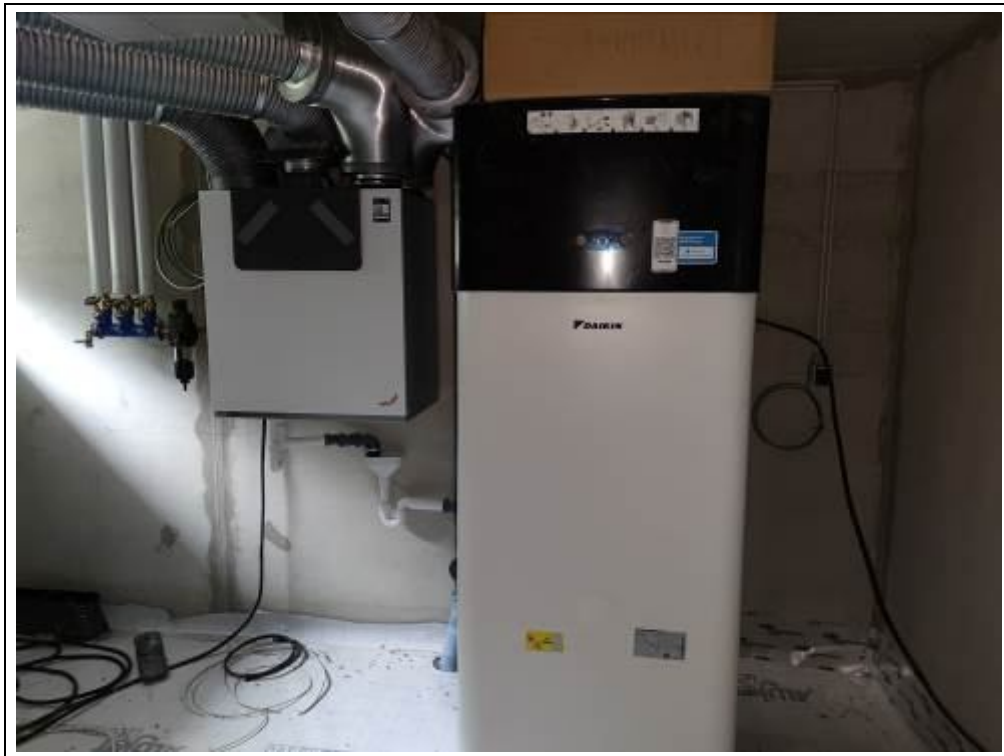
Blick auf die Lüftungsanlage und die Warmwasserbereitung
