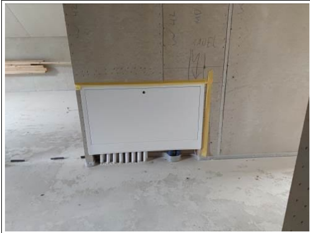
Blick auf eine Fußbodenheizungsverteilung
