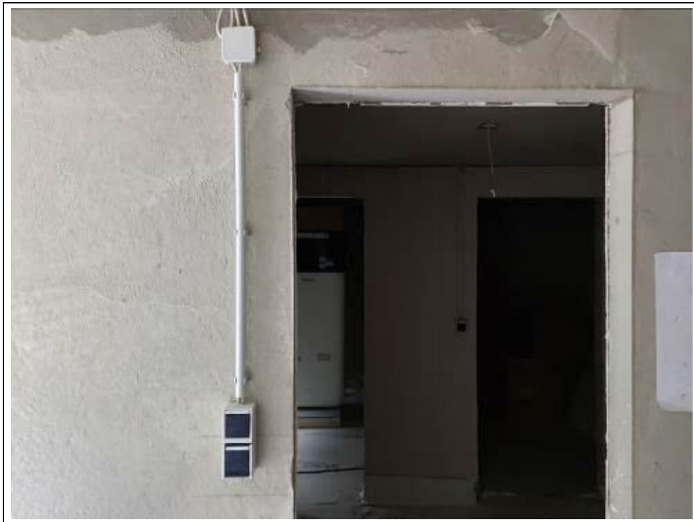
Blick auf eine Kellerinnenwand (Elektroleitungen im kompletten Keller auf Putz
