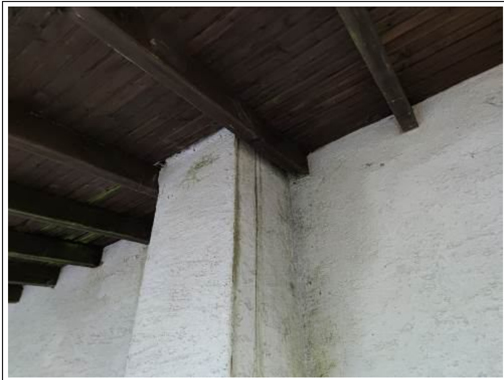
Blick auf den außen vorgesetzten Kamin mit Feuchtigkeitsschäden
