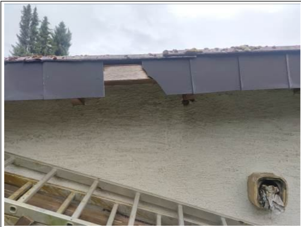
Blick auf Schäden an der Attikaverkleidung der Garage
