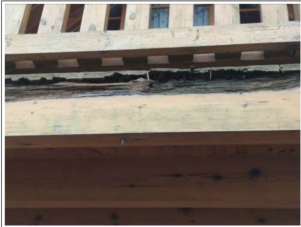
Blick auf einen angefaulten Deckenbalken im Balkonbereich
