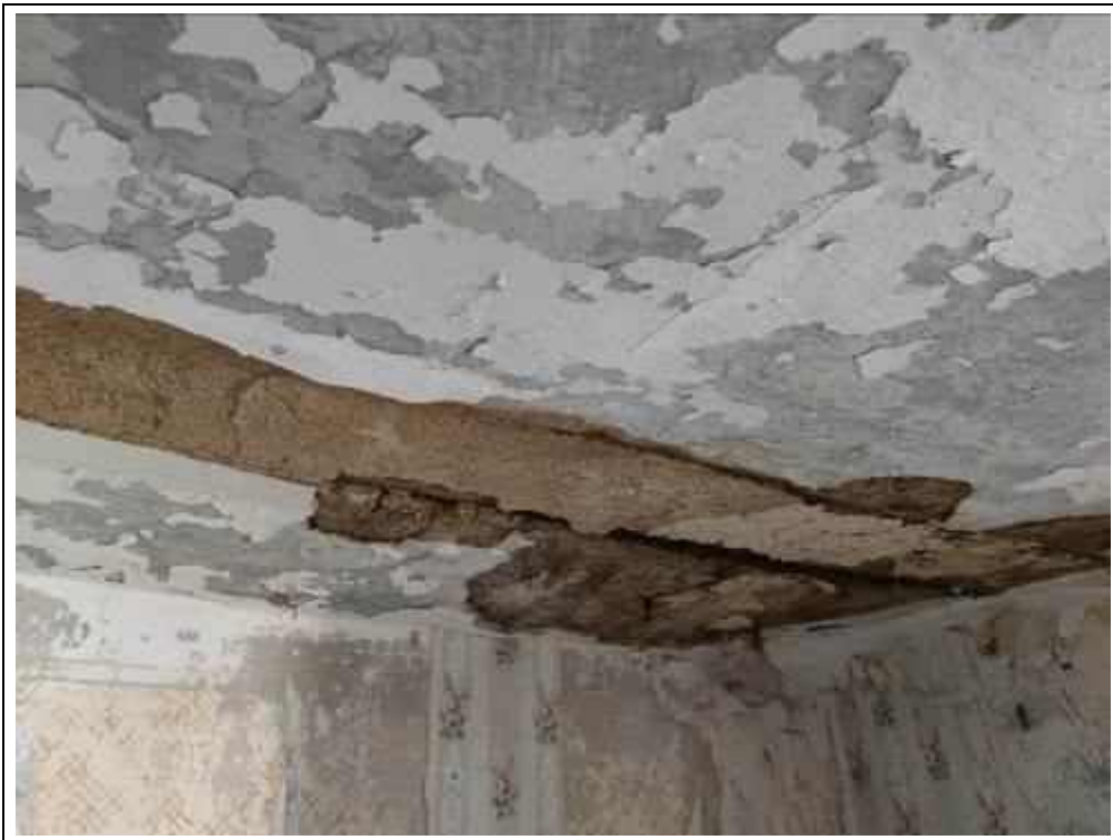
Blick auf starke Schäden an der Decke des Altbaus
