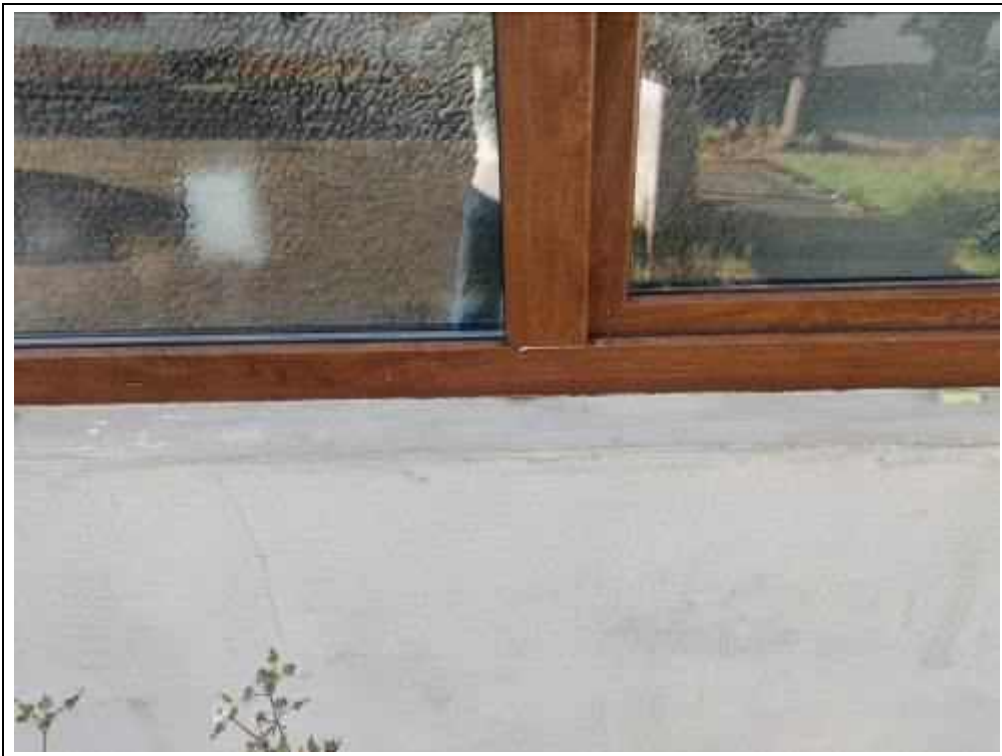
Blick auf eingeputzte Fenster ohne entsprechende Abdichtung und Fensterbach im renovierten Bereich
