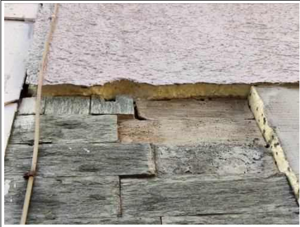
Blick auf Schäden im Bereich der Riemchenverkleidung / Übergang zum Wärmedämmverbundsystem
