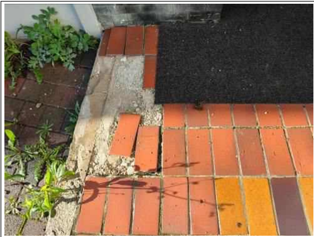
Blick auf Schäden an den Fliesen vor dem Hauseingang
