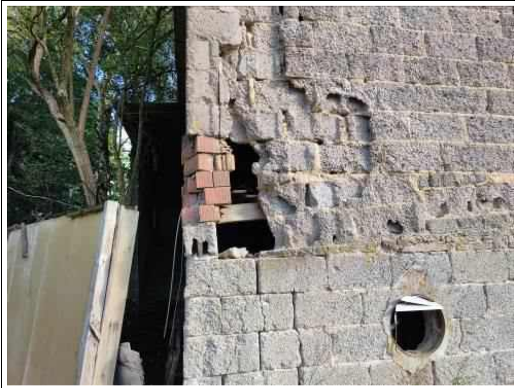
Blick auf Schäden am Mauerwerk des Hühnerstalls
