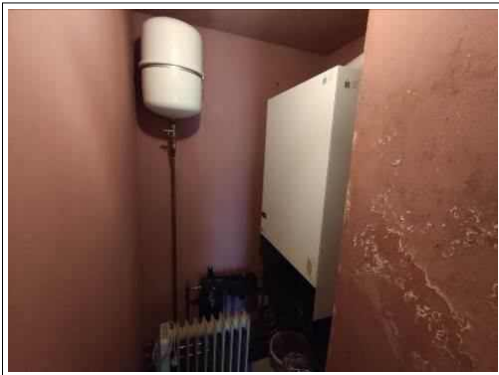
Blick auf die Heizungsanlage
