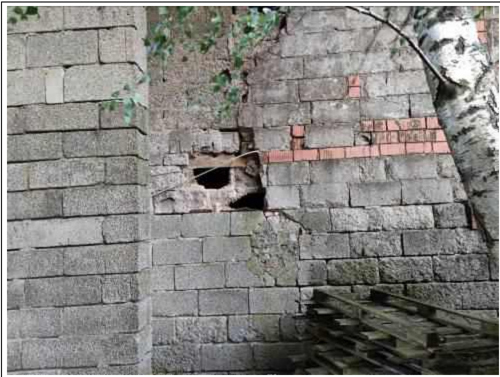
Blick auf Schäden im Mauerwerk des Hühnerstalls
