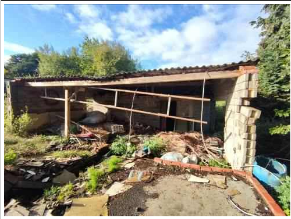
Blick auf die Reste des abgebrochenen Hühnerstall von Nordwesten
