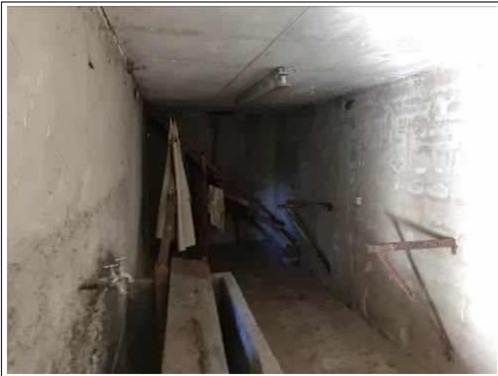
Blick in einen Raum des tlw. abgebrochenen Hühnerstall
