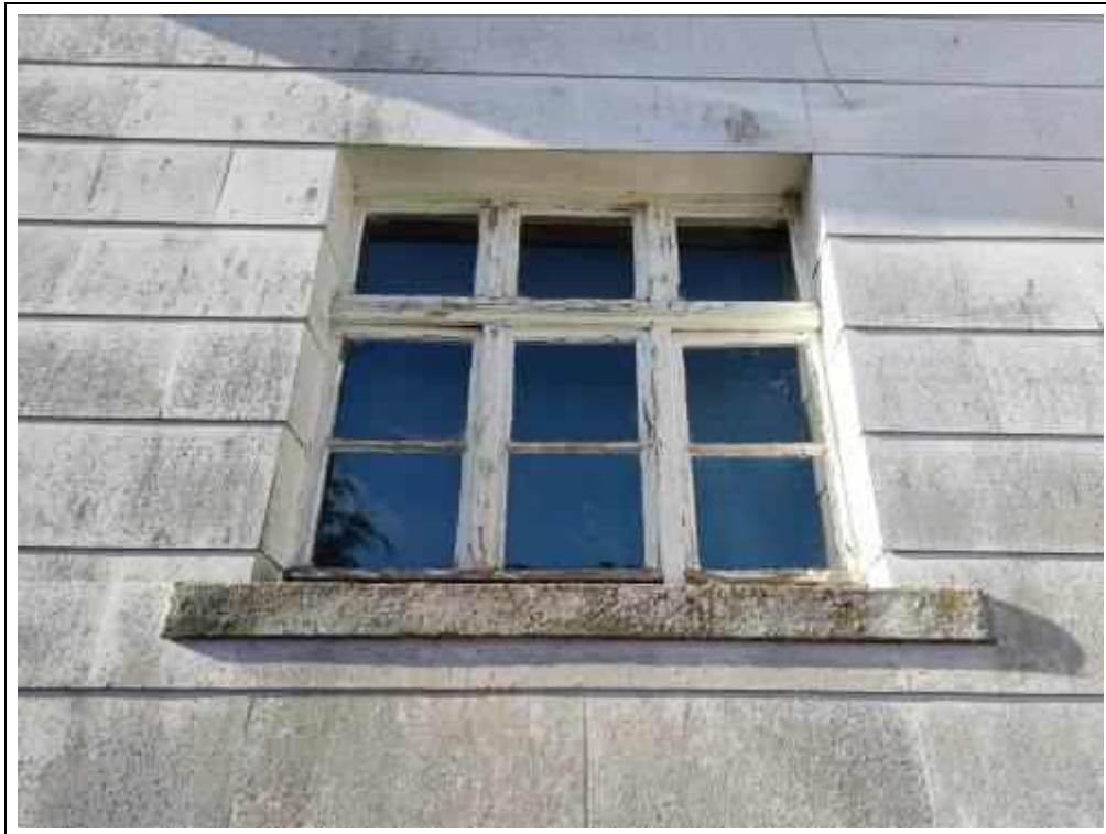
Blick auf den Zustand der Fenster im alten Haus
