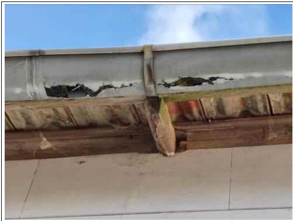
Blick auf die durchgerostete Dachrinne am alten Wohnhaus
