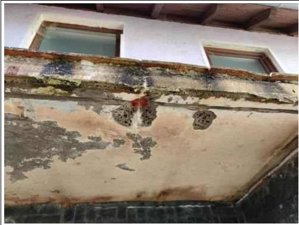
Blick auf Schäden an der Hauseingangsüberdachung
