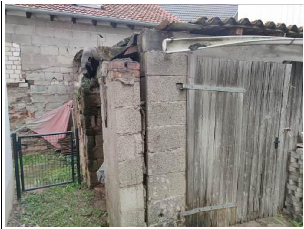
Blick auf die Garage mit statischen Schäden
