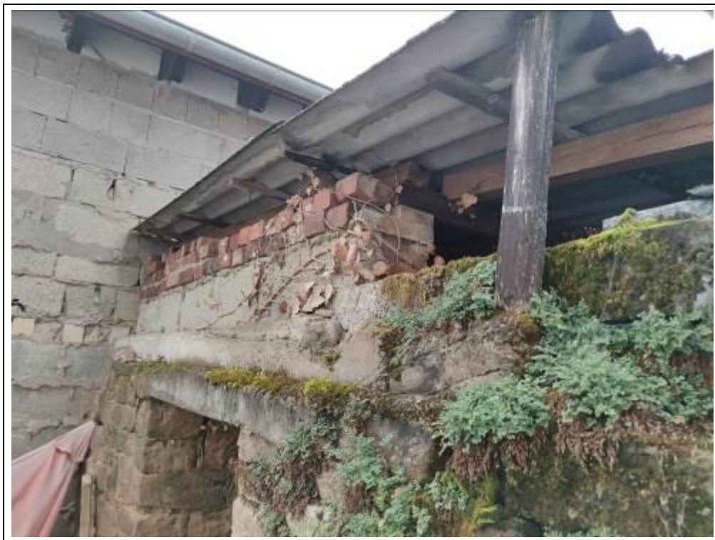
Blick auf den Zustand der Garage
