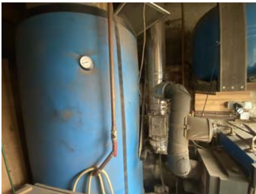
C5: Beispiel Haustechnik Werkstatt
