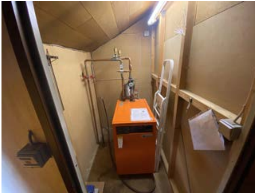
C6: Beispiel Haustechnik Werkstatt
