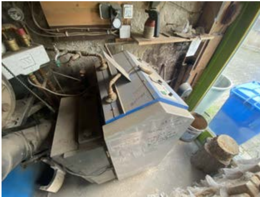
C4: Beispiel Haustechnik Werkstatt
