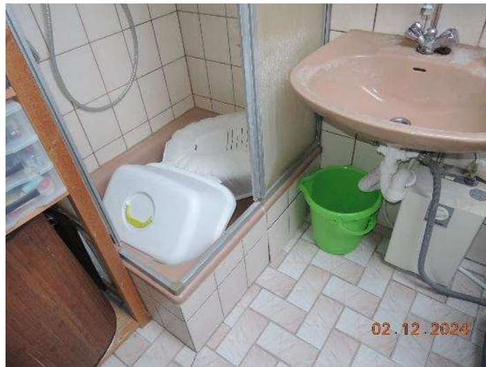
Abb. 17: Duschbad im Dachgeschoss
