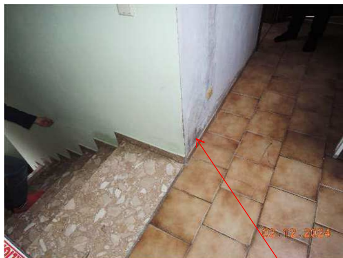
Abb. 14: Treppe zu den Räumen im Dachgeschoss, Feuchtigkeitsschaden
