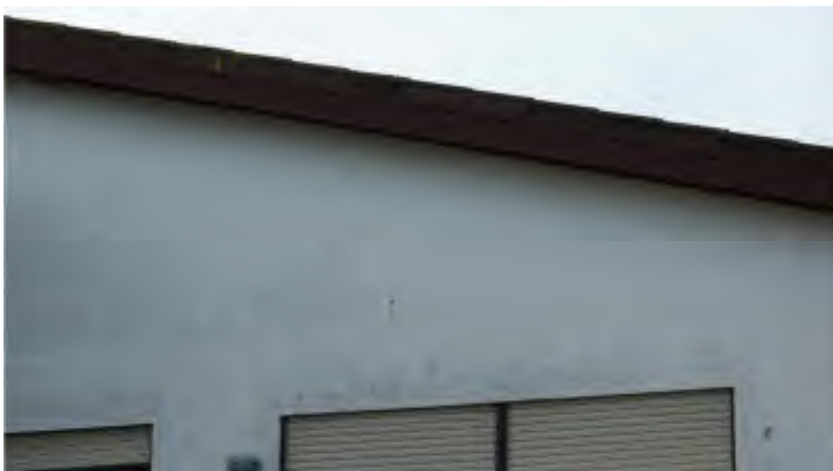
Fassade mit Verschmutzungen, Abnutz.ersch.
