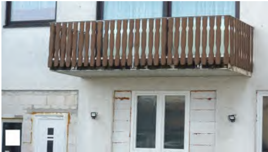
Balkon mit Feuchteschäden
