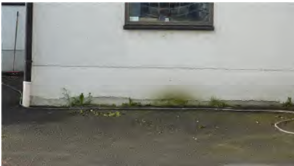
Haussockel partiell mit Feuchte-/Putzschäden
