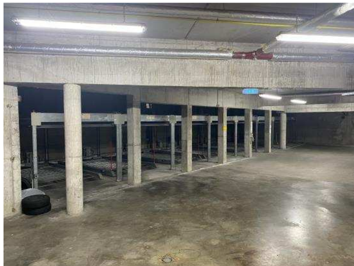
Bild 14: CombiLift-Anlage im Kellergeschoss (Tiefgarage) des Gebäudekomplexes
