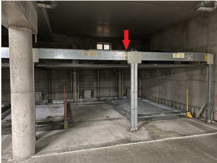
Bild 15: Dem Bewertungsobjekt zugeordneter Stellplatz (Nr. 12) im oberen Bereich der Combi-lift-Anlage in der Tiefgarage
