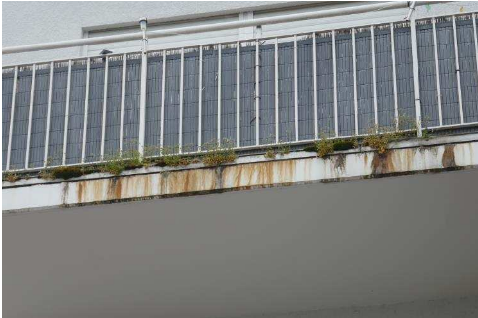
Bild 21: Schaden an der Kragplatte eines Balkons auf der Westseite des Gebäudekomplexes
