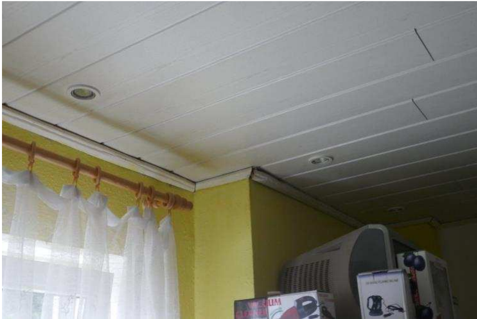
Bild 9: Deckenleisten im Wohnbereich 2 des Bewertungsobjektes nach Wasserschaden in der darüberliegenden Obergeschosswohnung
