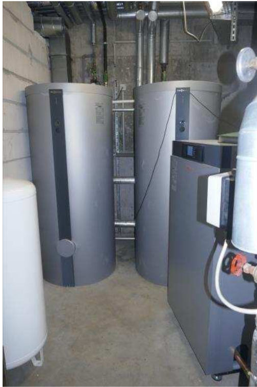
Bild 13: Erneuerte Heizungsanlage im Kellergeschoss (Hausanschlussraum) des Gebäudekomplexes
