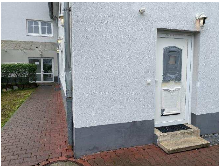
Bild 22: Schäden an Fallrohr und Außenzugang zu anderer Wohnungseigentumseinheit
