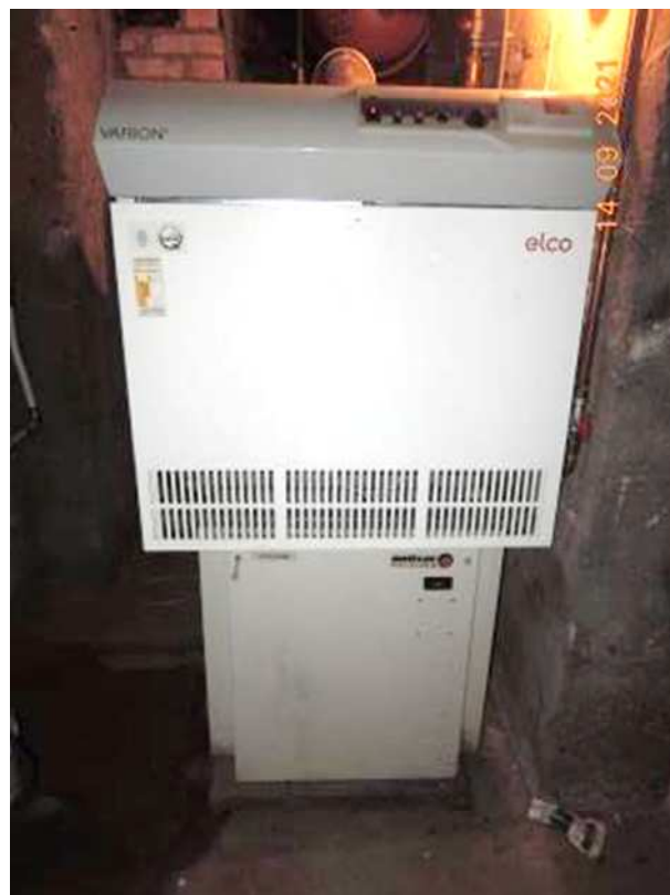
Bild 28: Heizungstechnik im KG des Seitengebäudes
