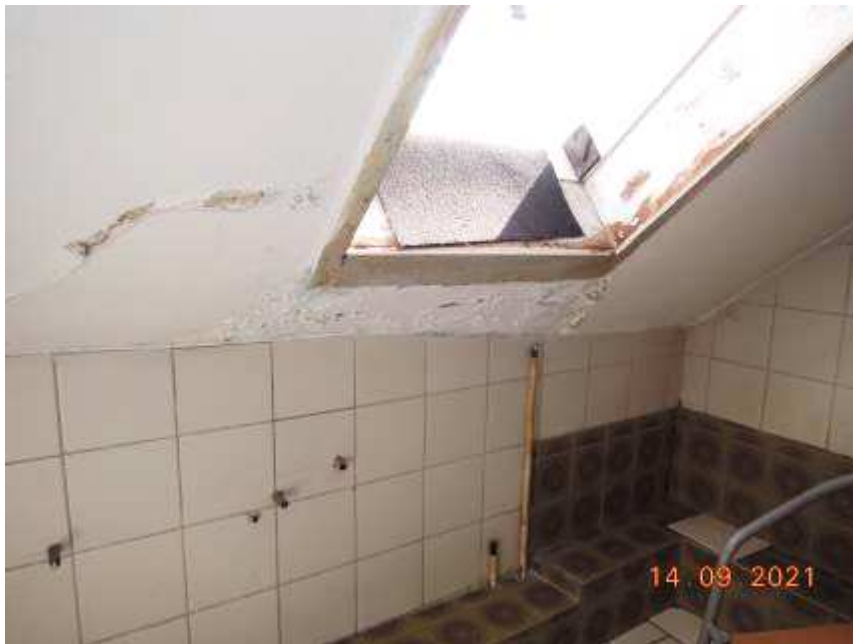
Bild 17: Feuchtigkeitsschäden im Duschbad (Dach)
