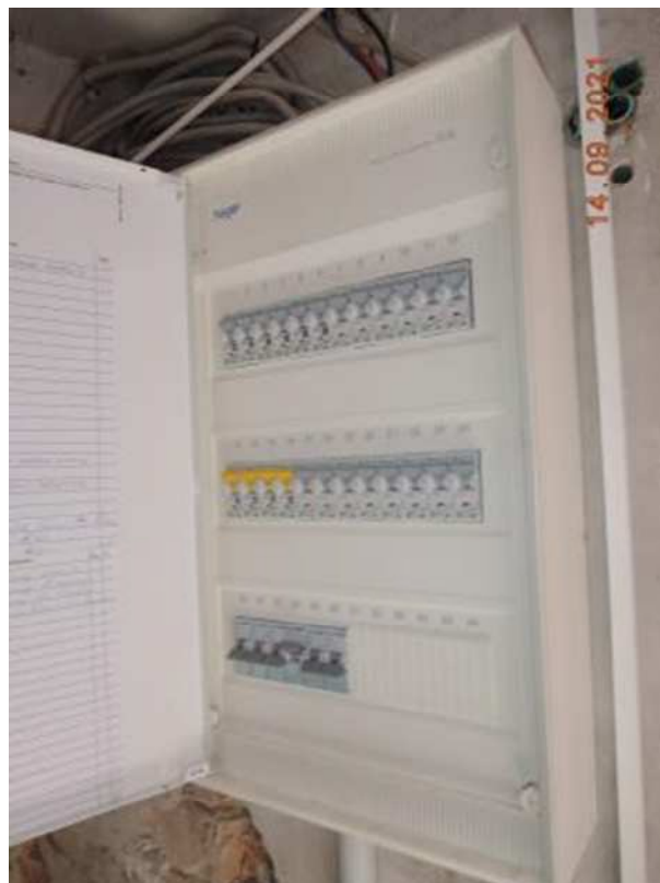
Bild 24: Sicherungskasten im EG
