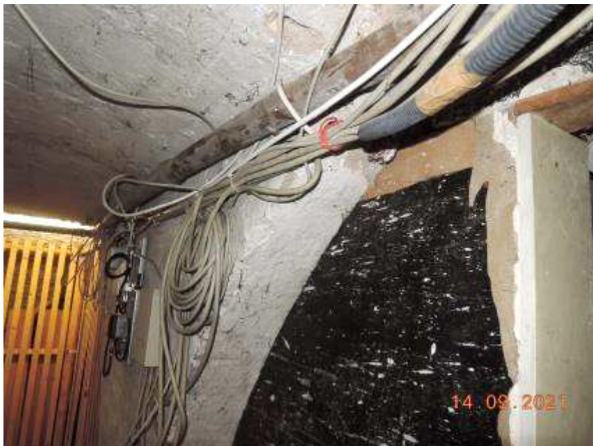
Bild 26: Detailaufnahme im KG, Elektroinstallation
