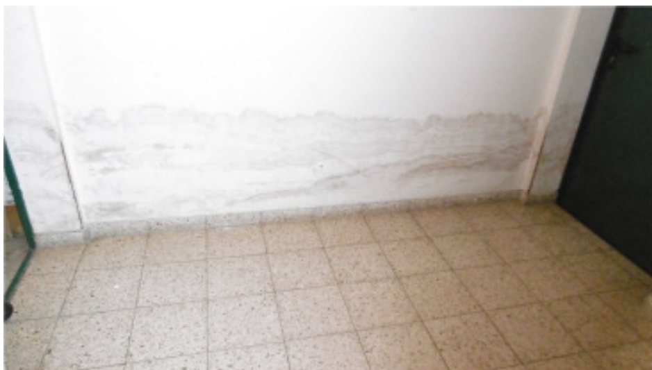
ältere Sockelfeuchteschäden im Flur KG
