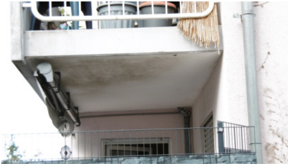
Balkon mit partieller Schadstelle
