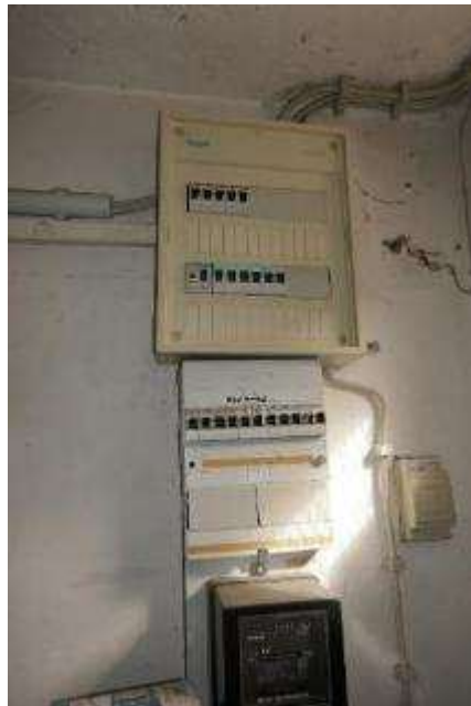
Bild 8: Sicherungsverteilung und Stromzähler im Keller
