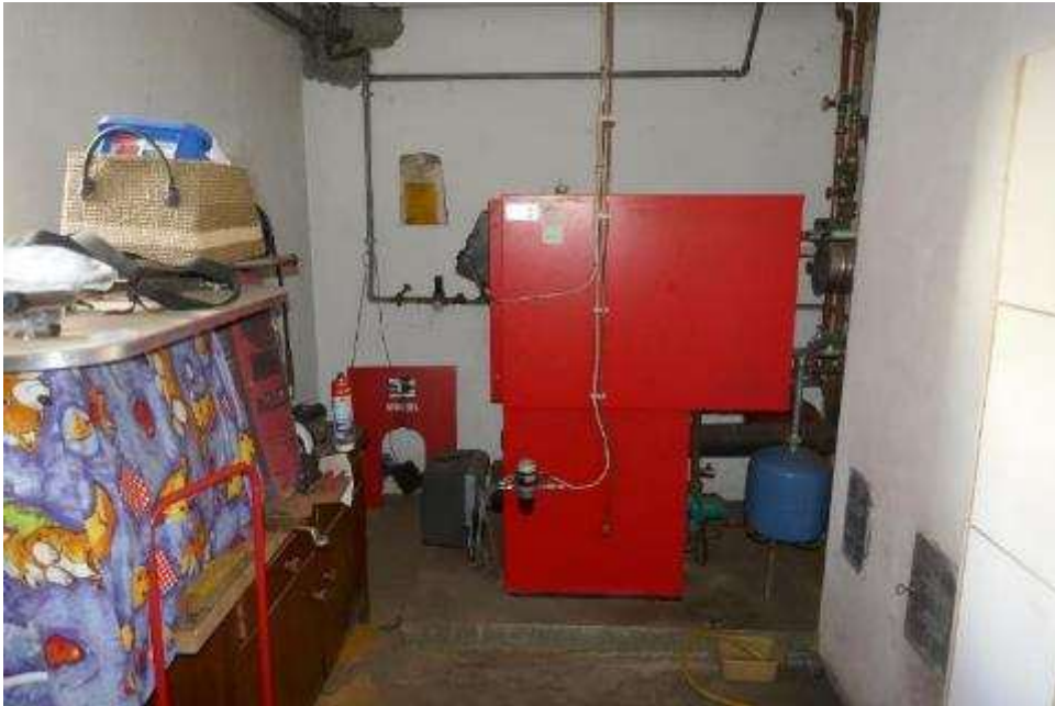
Bild 9: Heizungsraum im Keller
