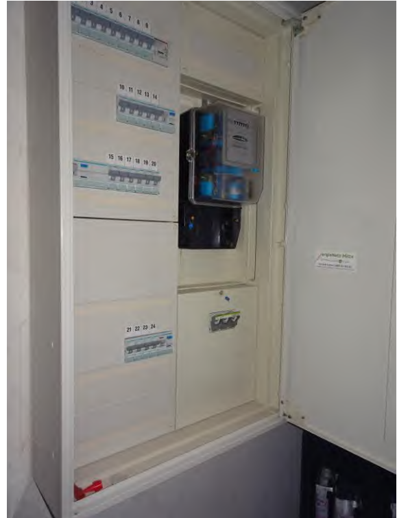
Elektro- Hauptverteilung 2008 erneuert
