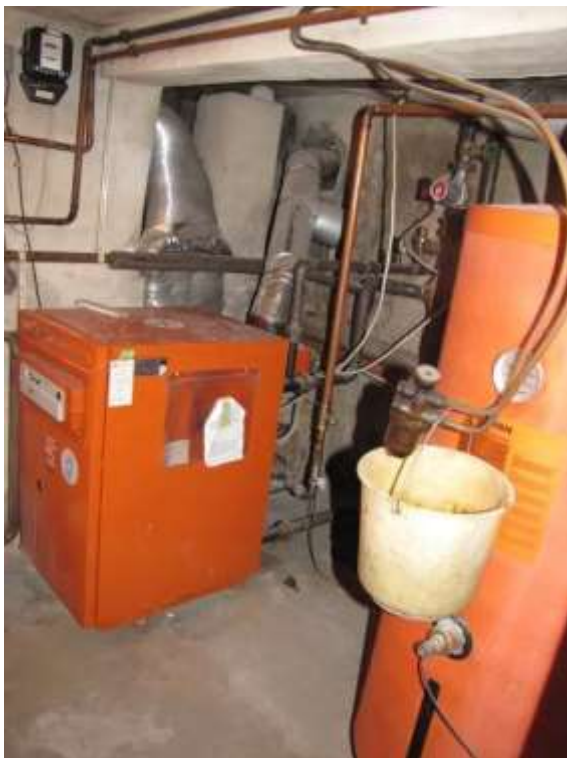
Gasheizung im Kellergeschoss (2012)
