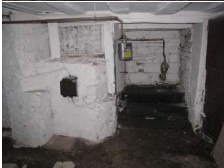
Gaszähler, Hauptwas- serzähler und Stromanschluss im Keller Richtung Marktplatz (2012)
