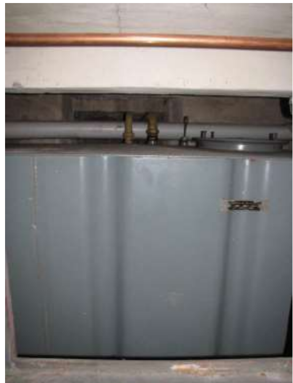
Kellergeschweißter Öltank (Außer Betrieb) (2012)
