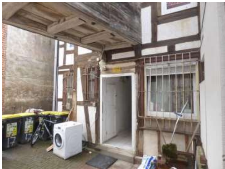
Hintereingang von der Ostseite in das Hauptgebäude und nicht mehr nutzbarer Übergang zum Nebengebäude
