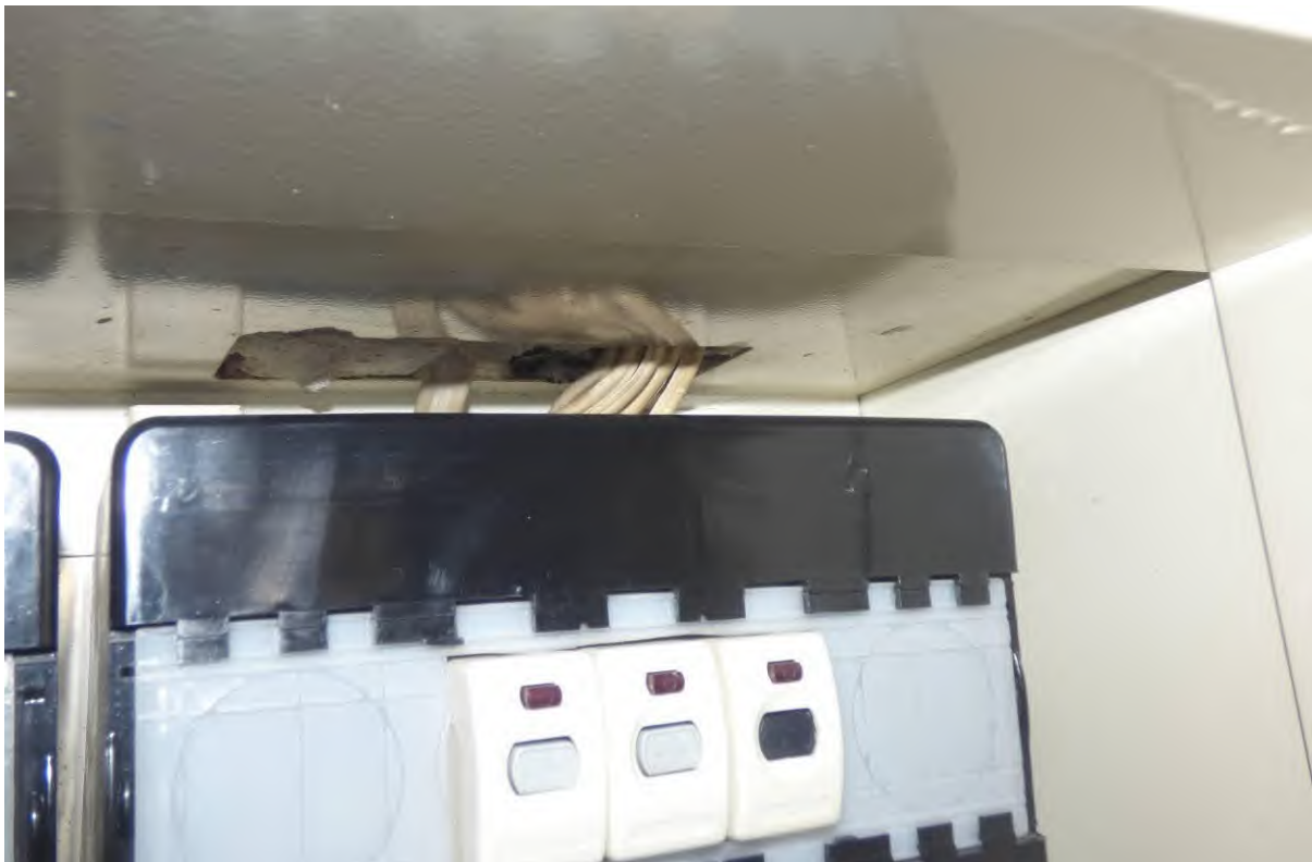
Detail Verteilung: Vermutlich Stegleitungen ohne Schutzleiter
