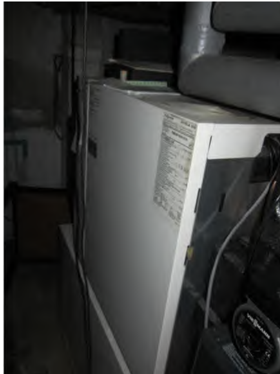
Bild 31: Zustand Öl- Zentralheizung
