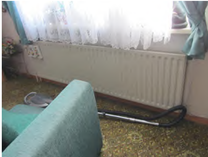
Bild 9: Wohnung 1, Zustand Heizkörper
