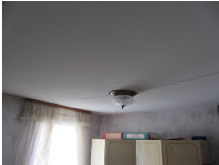
Bild 13: Wohnung 1, durchhängende Decke im Schlafzimmer
