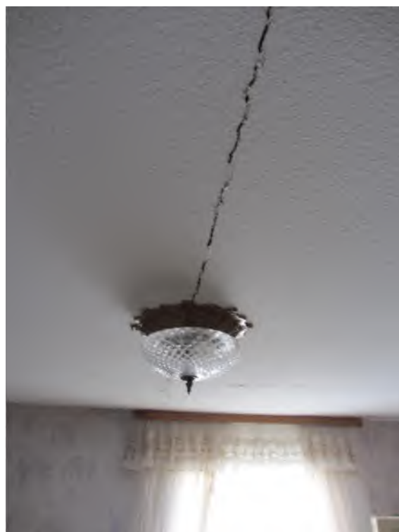
Bild 14: Wohnung 1, durchhängende Decke im Schlafzimmer
