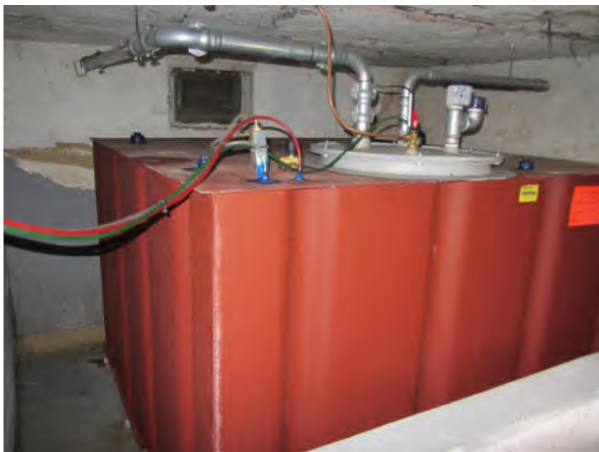
Bild 34: Öltank aus Stahl
