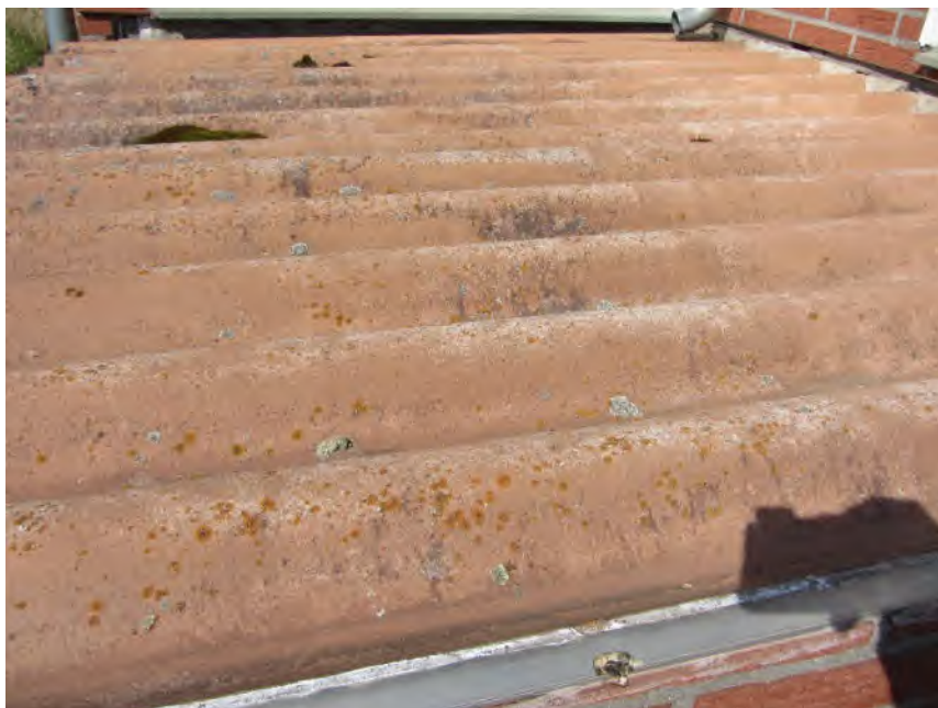
Bild 20: Dacheindeckung Abstellraum verm. Asbesthaltig
