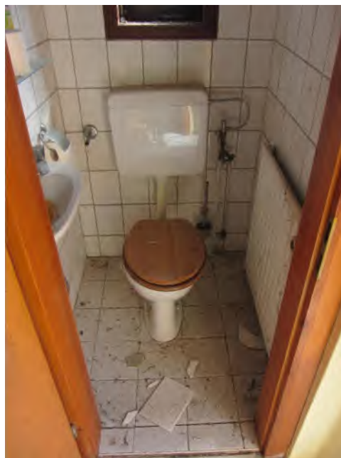
Bild 22: Wohnung 2, WC mit Setzungsrissen und defekten Fliesen
