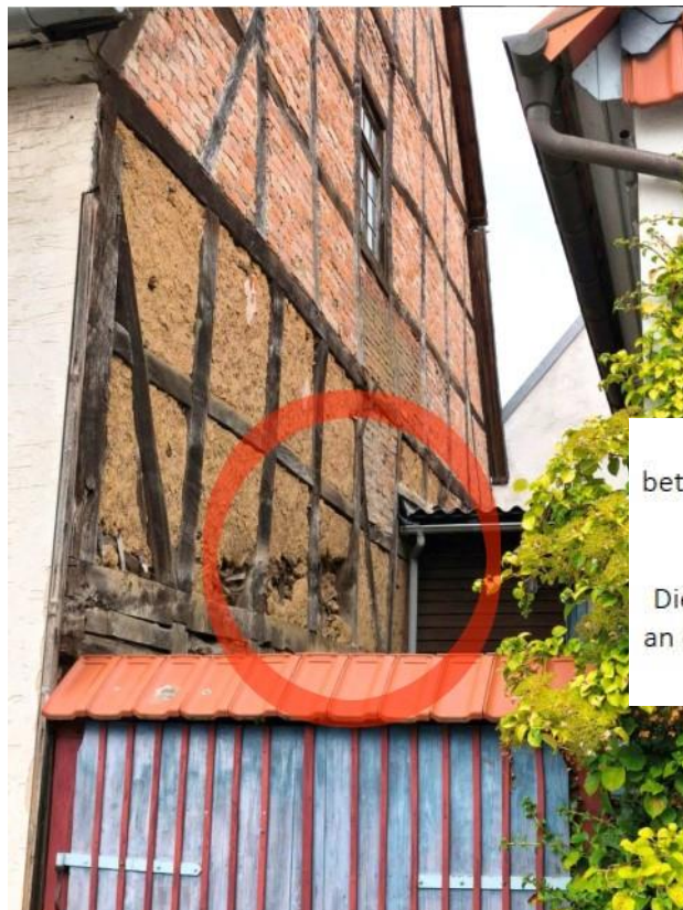
Bild 3 / Giebelfassade – Darstellung des Schadens – Bezug zur Außenwand
