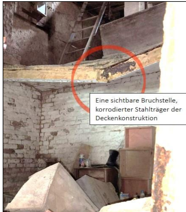
Bild 2 / Raum Stallung - Schadensbild
