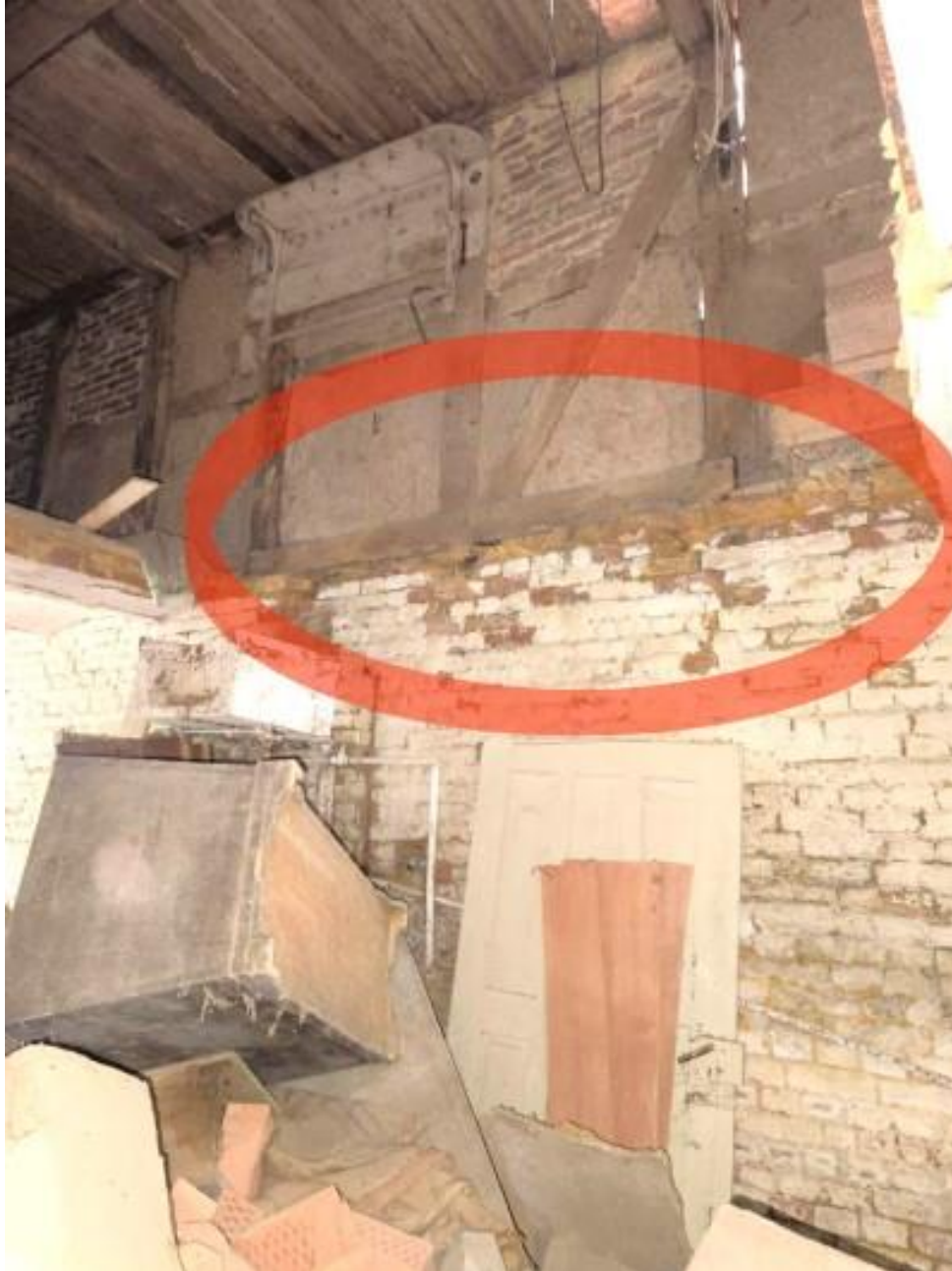
Bild 1 / Raum Stallung – Schadensbild – fehlender Deckenverbund zur Außenwand (Giebel zum Nachbarn)
