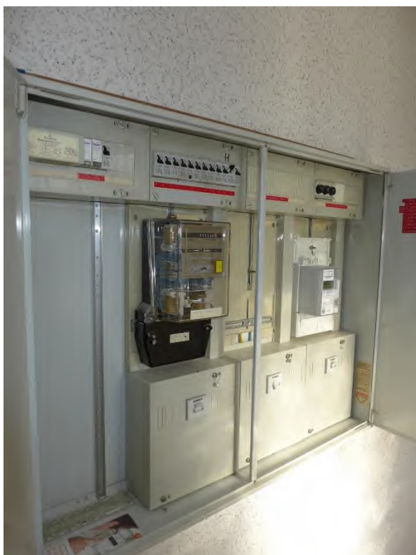
19 a Elektroverteilung Wohnhaus 1975
