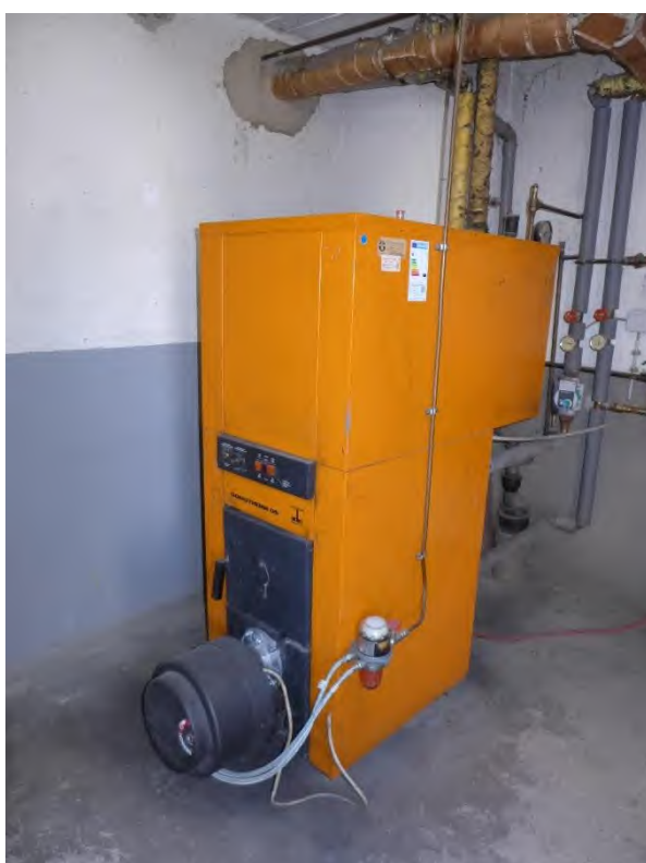
20 a Heizung Wohnhaus 1975
