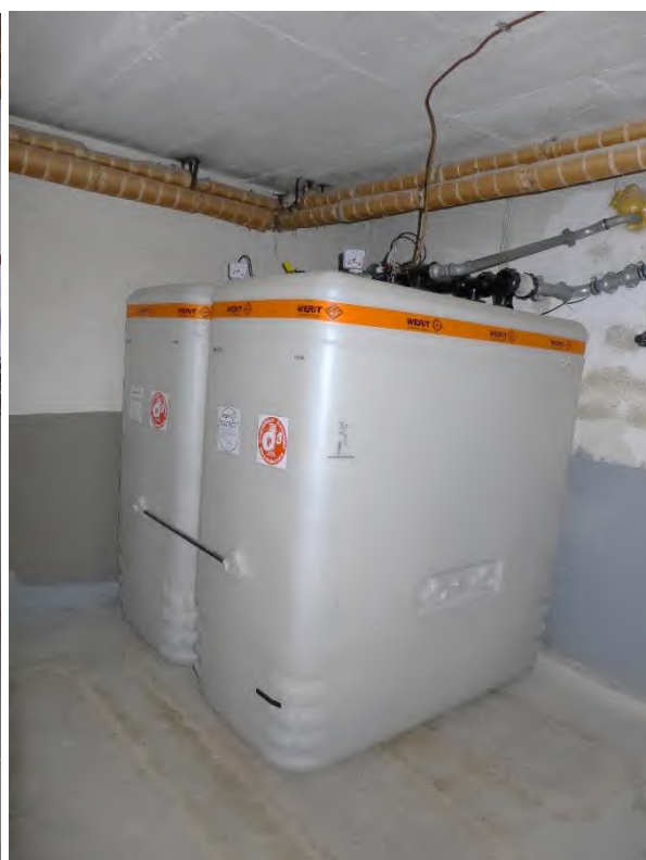
20 b Öltankanlage Wohnhaus 1975
