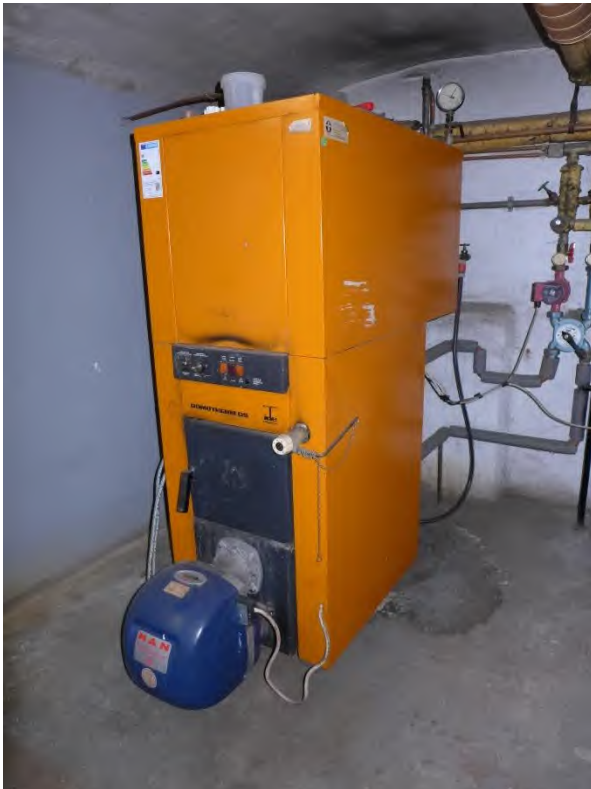
9 a Heizung Altbau im Kellergeschoss
