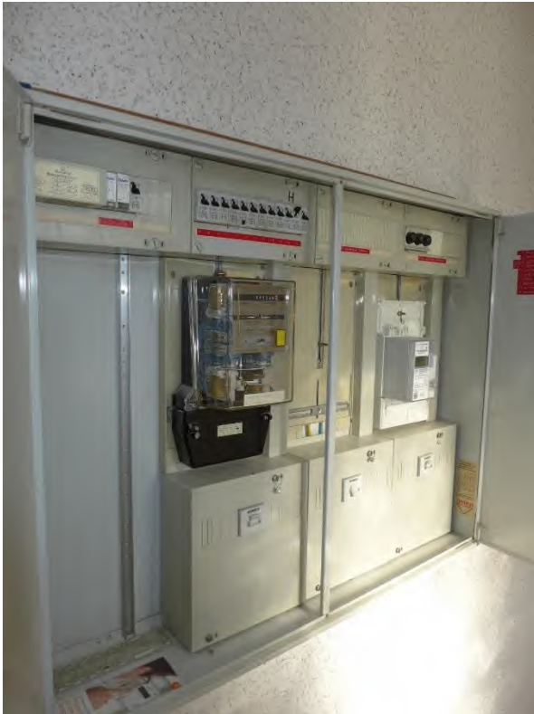
19 a Elektroverteilung Wohnhaus 1975
