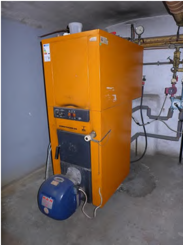
9 a Heizung Altbau im Kellergeschoss
