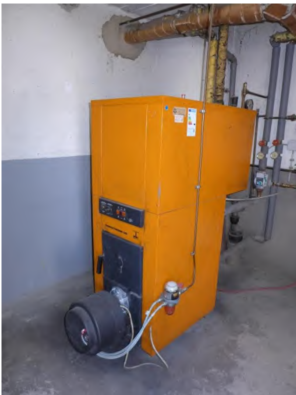
20 a Heizung Wohnhaus 1975
