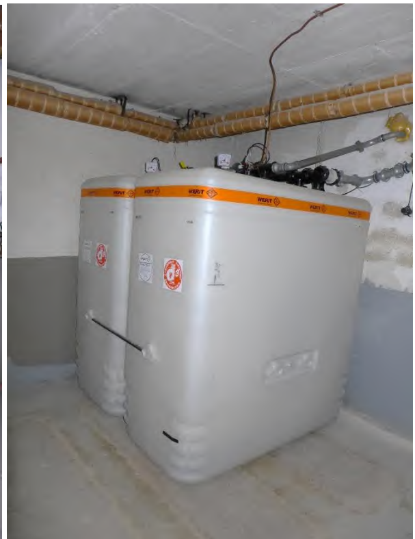
20 b Öltankanlage Wohnhaus 1975
