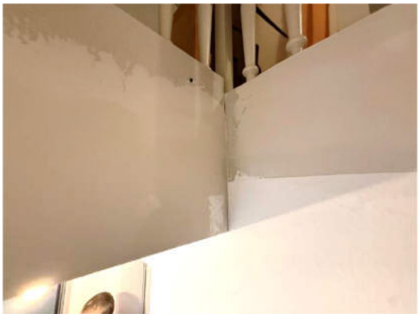
Abb. 11: Foto des SV; z.T. unfertige Gipskartonverkleidungen (DG, Vorbereich/Treppenhaus)
