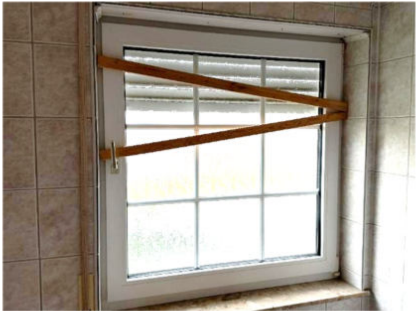
Abb. 10: Foto des SV; z.T. Fenster defekt (WE 3, Bad)
