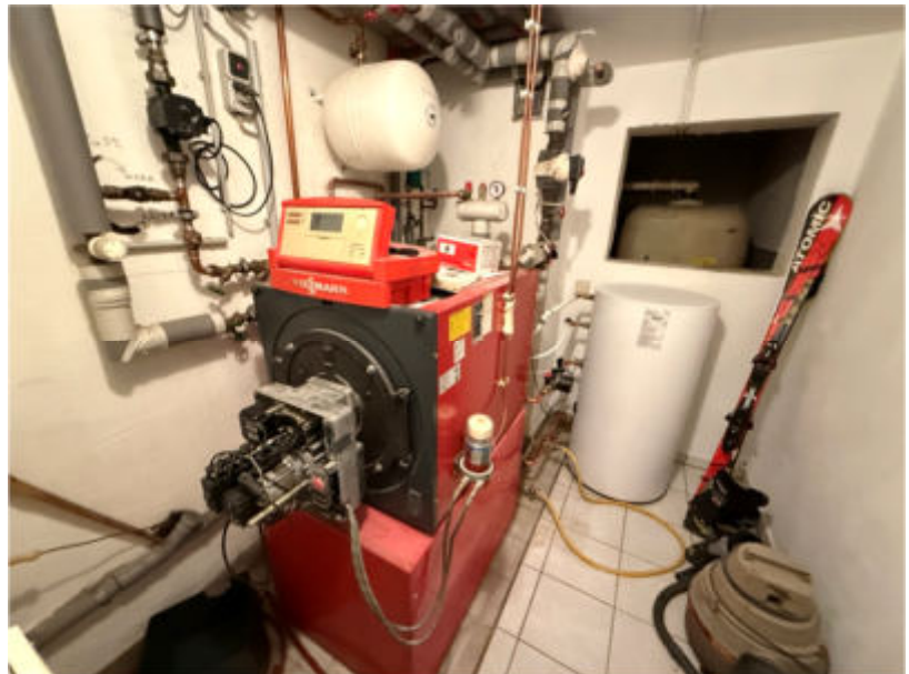
Foto 14 des SV: Kellergeschoss, Technik
