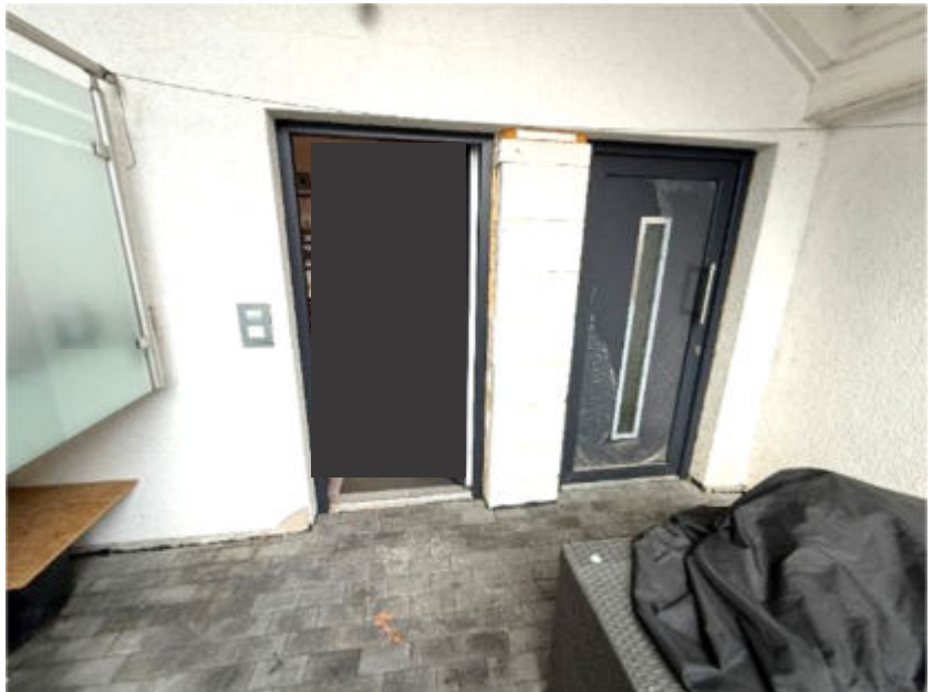
Abb. 8: Foto des SV; z.T. offene Bauteilanschlüsse im Hauseingangsbereich Wohneinheit 1, Abstellraum (ehem. Garage)
