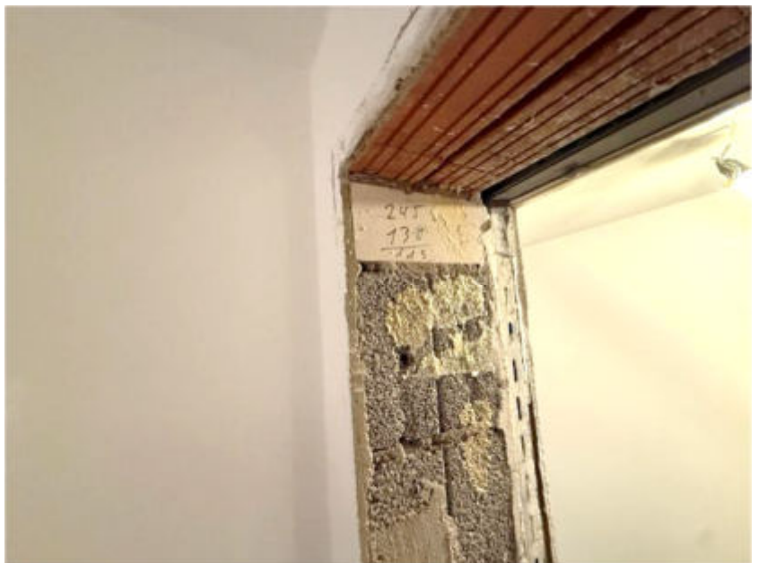
Abb. 13: Foto des SV; z.T. fehlende Türen und Türbekleidungen (KG Freizeit- raum)
