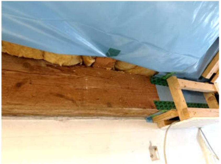
Abb. 6: Foto des SV; z.T. offene Bauteilanschlüsse im Dachbereich des Abstellraums (ehem. Garage)
