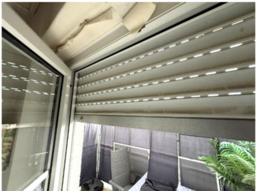
Abb. 9: Foto des SV; z.T. Feuchteschaden, Tapetenablösung (WE 3, Küche)
