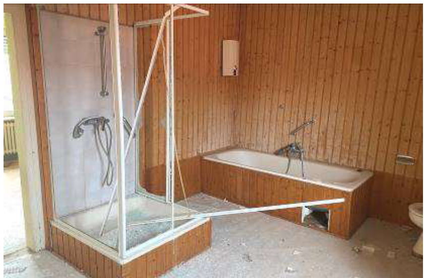
Abb. 12: Foto des SV; Sanitärobjekte überaltert/schadhaft
