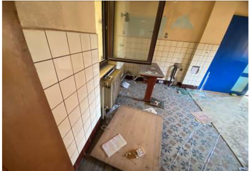
Abb. 10: Foto des SV; Boden-, Wandbekleidungen schadhaft, überaltert
