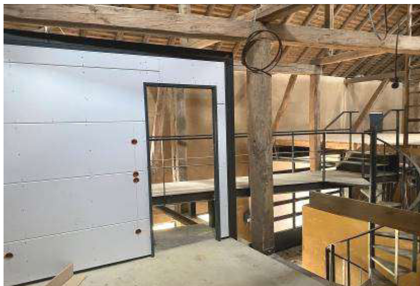
Abb. 19: Foto des SV; z.T. unfertige Anschlüsse, Innentüren fehlend
