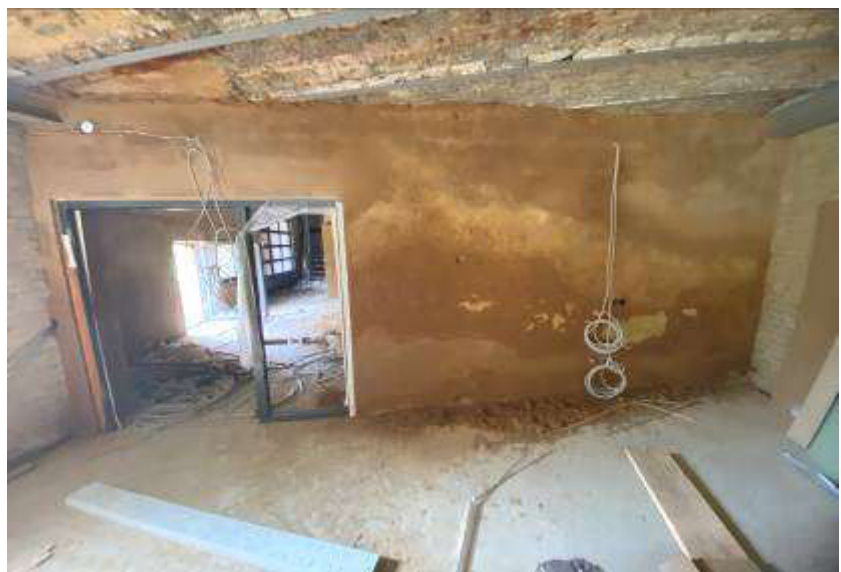
Abb. 23: Foto des SV; z.T. Feuchteschäden in Wandbereichen
