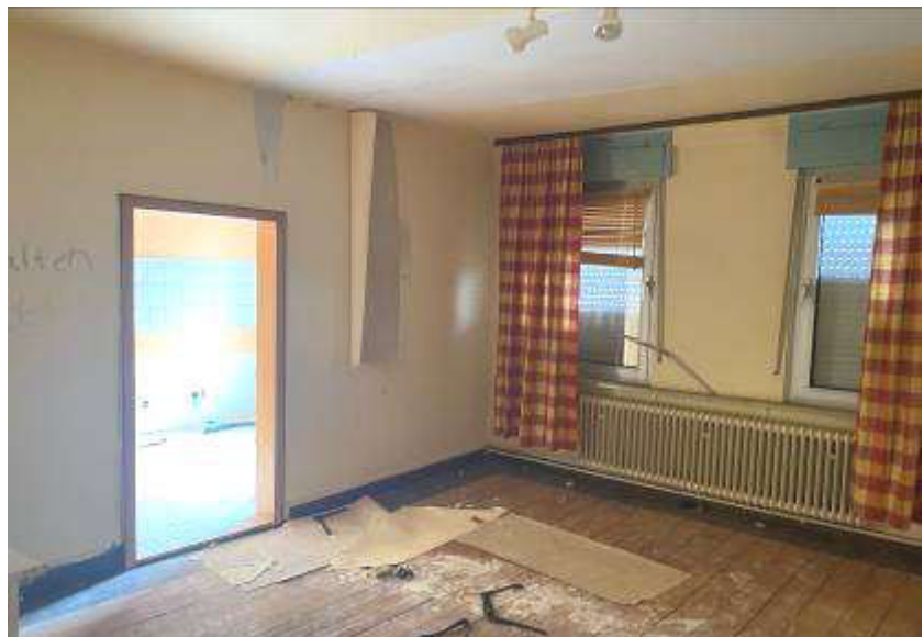
Abb. 8: Foto des SV; Boden-, Wand-, Deckenbekleidungen schadhaft
