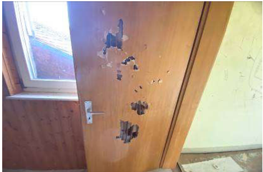
Abb. 11: Foto des SV; z.T. Türen schadhaft
