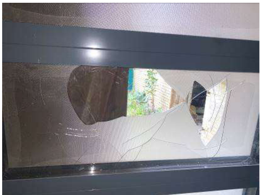
Abb. 14: Foto des SV; Glasbruch am Sektionaltor
