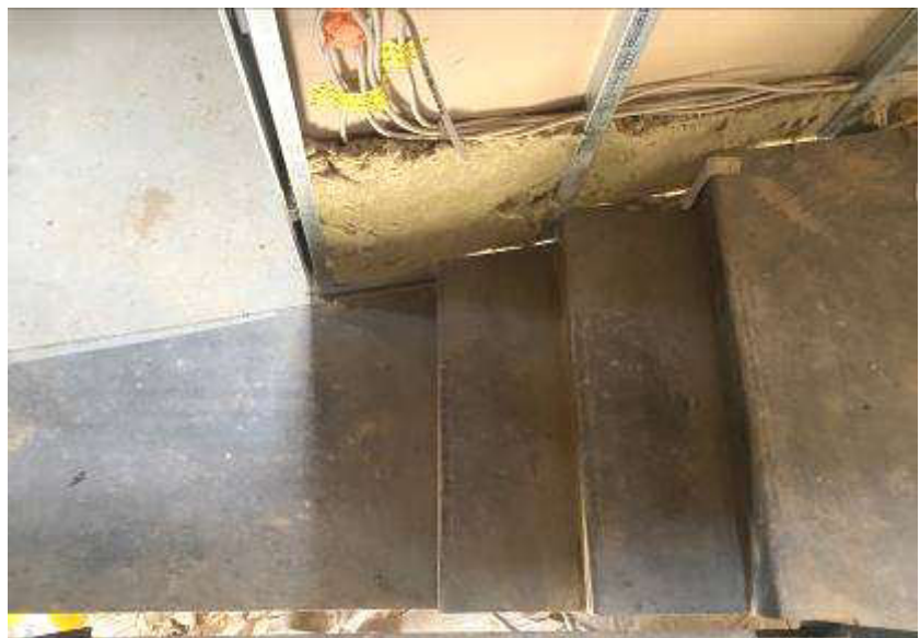
Abb. 22: Foto des SV; z.T. Wandanschlüsse/-bekleidungen fehlend
