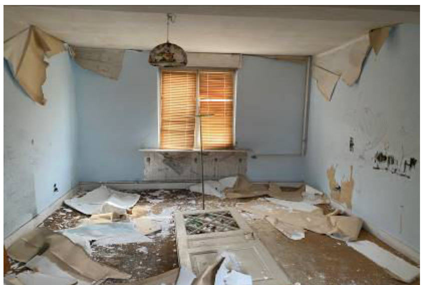
Abb. 9: Foto des SV; Boden-, Wand-, Deckenbekleidungen schadhaft
