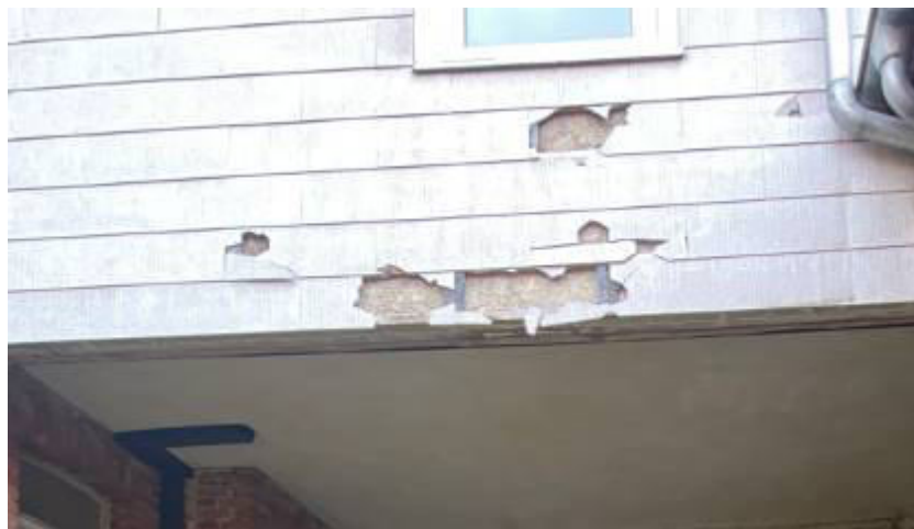
Abb. 5: Foto des SV; z.T. Fassade hofseitig schadhaft
