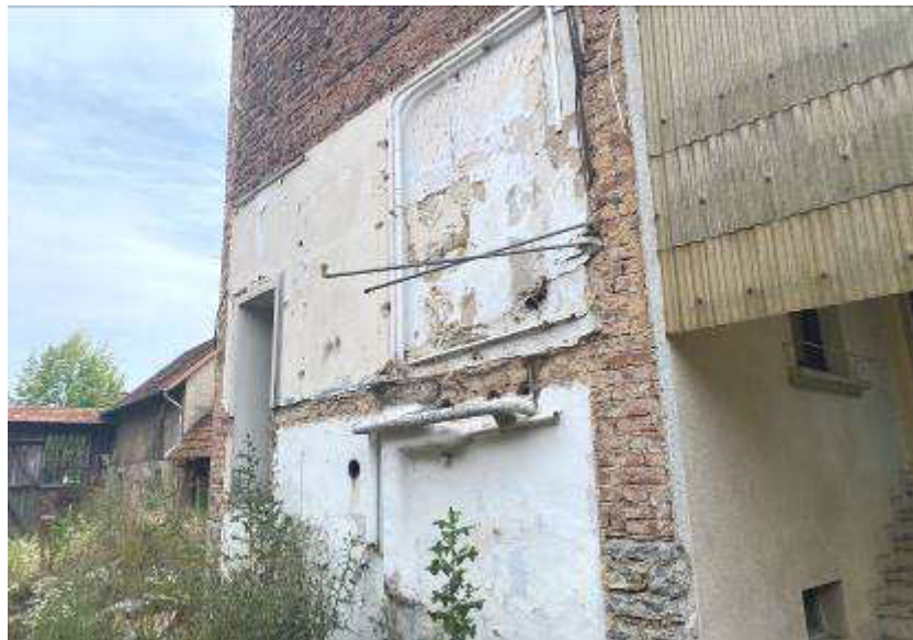
Abb. 4: Foto des SV; z.T. Fassade hofseitig stark schadhaft
