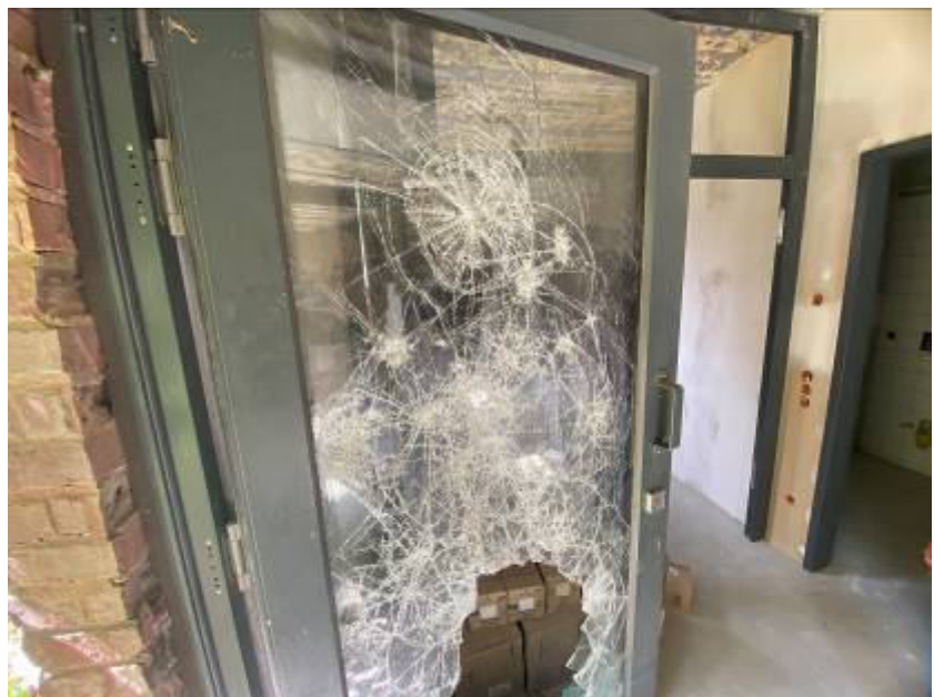
Abb. 13: Foto des SV; Glasbruch an Eingangstür
