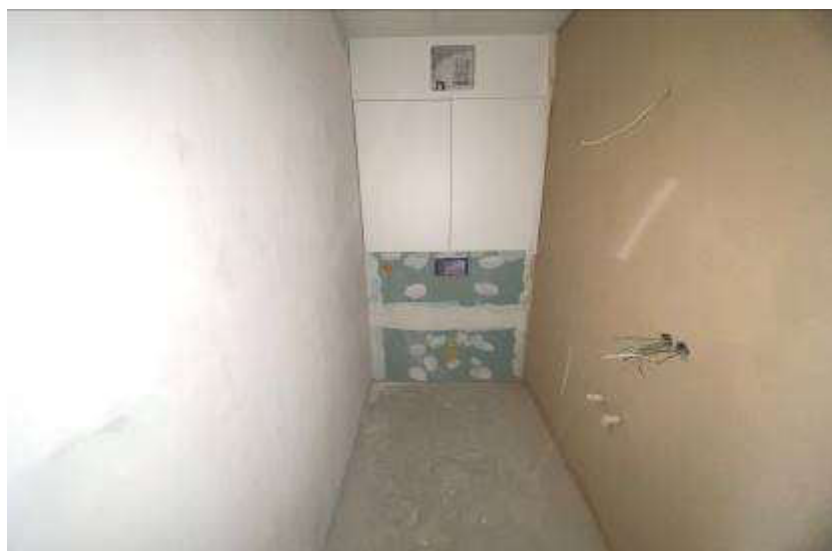
Abb. 20: Foto des SV; z.T. unfert. Wandbekleidung, Sanitärobjekte fehlend
