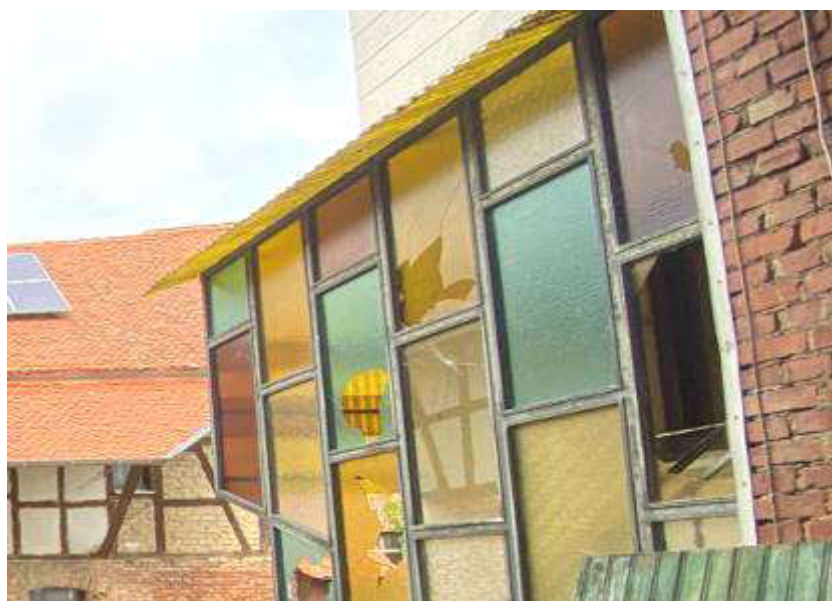
Abb. 6: Foto des SV; z.T. Seitenverkleidung Eingangsüberdachung schadhaft
