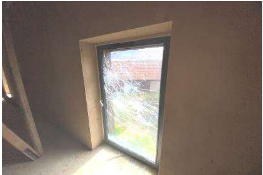
Abb. 15: Foto des SV; Glasbruch Fenstertür
