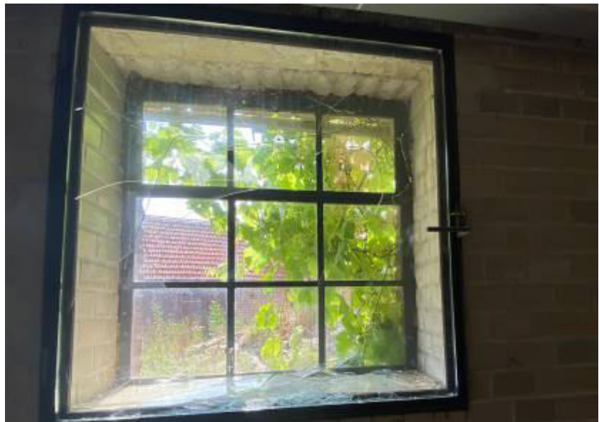
Abb. 16: Foto des SV; Glasbruch an Fenstern
