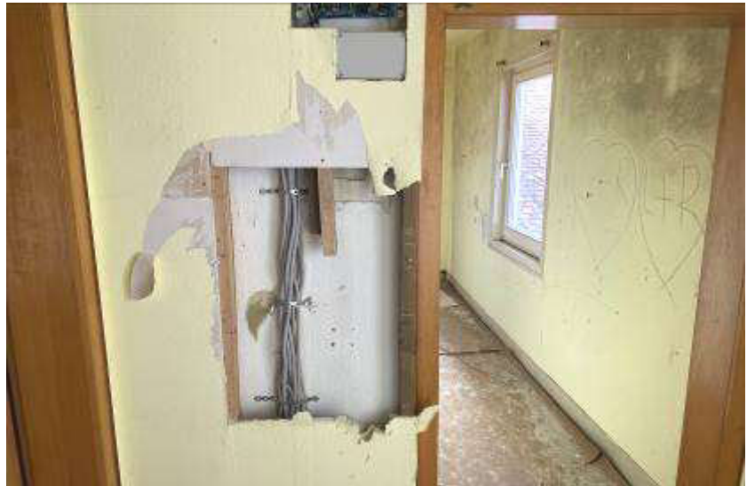
Abb. 7: Foto des SV; Wandbekleidungen schadhaft, überaltert
