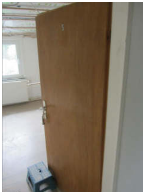
Bild 62: Obergeschoss: Zustand Innentüren
