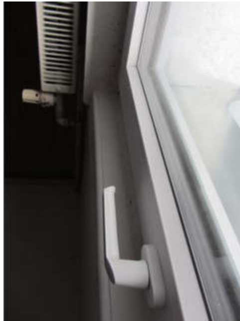
Bild 65: Obergeschoss: Zustand Fenster
