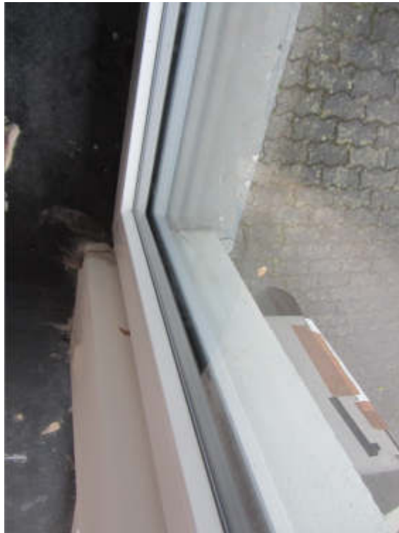
Bild 99: Erdgeschoss: Zustand Fenster
