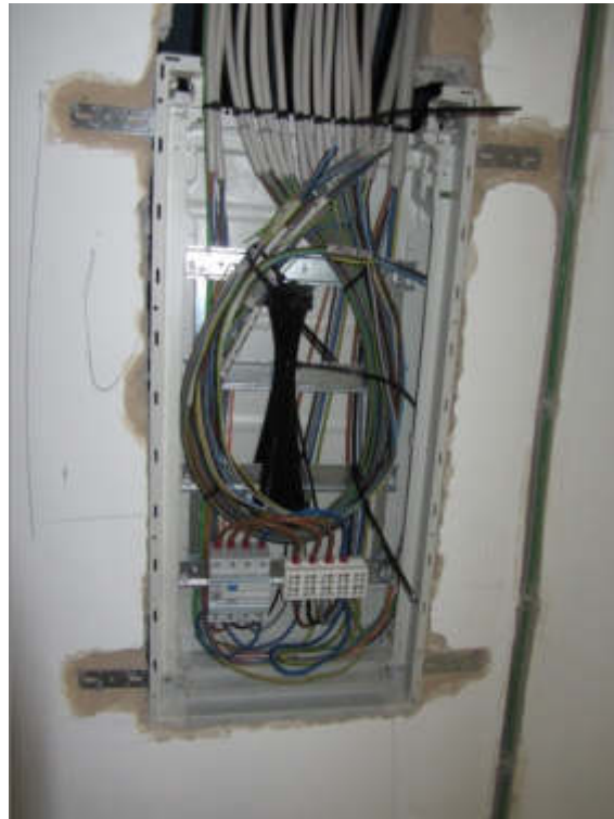
Bild 59: Obergeschoss: z.T. erneuerte Elektrik
