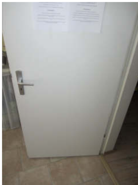
Bild 50: Obergeschoss: Zustand Innentüren
