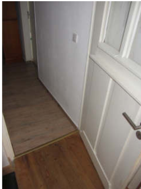
Bild 46: Obergeschoss: Zustand Innentüren
