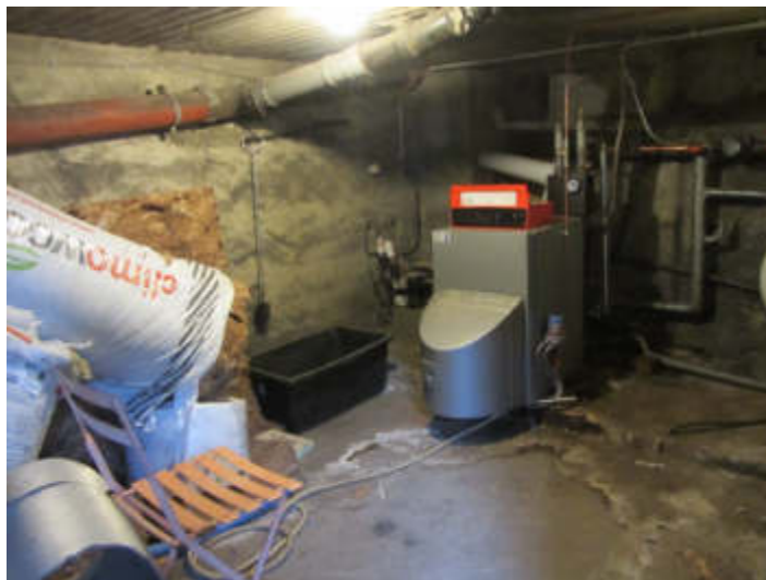
Bild 106: Heizungsraum mit Ölzentralheizung
