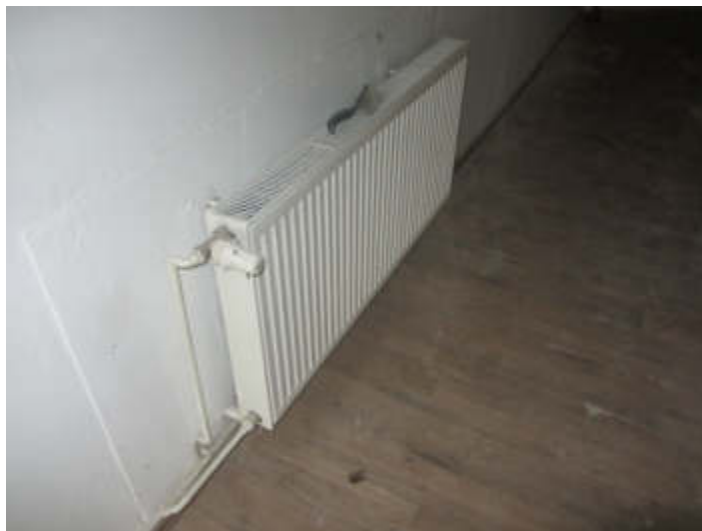
Bild 60: Obergeschoss: Zustand Heizkörper
