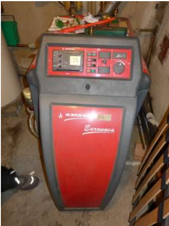
15 a Heizung KG
