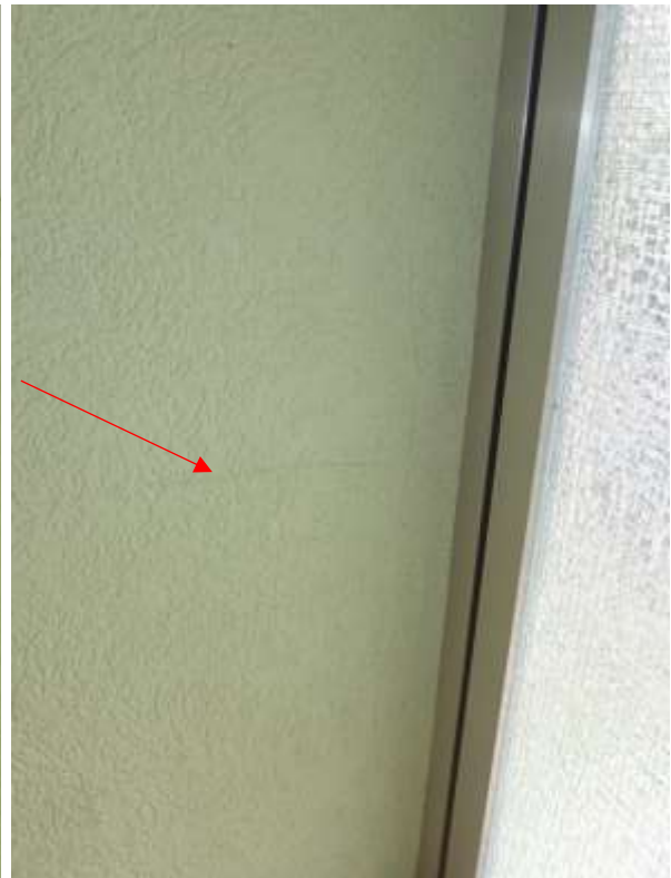
13 b Rissbildung Treppenhaus
