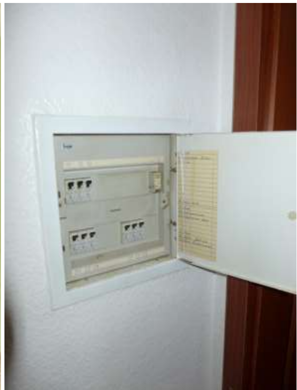
16 b Elektroverteilung Wohnung Nr. 2, OG
