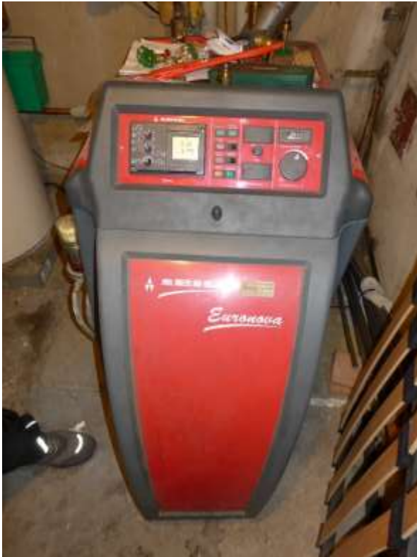
15 a Heizung KG
