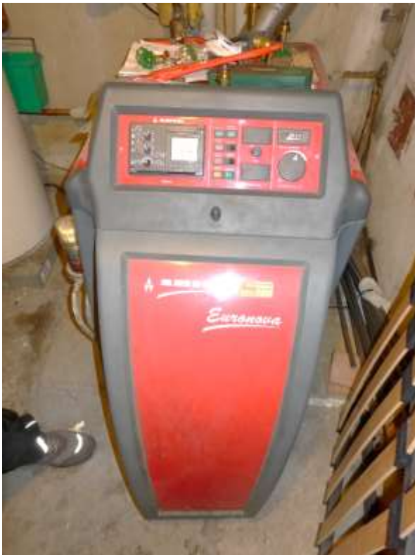
15 a Heizung KG
