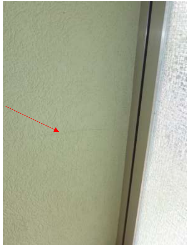
13 b Rissbildung Treppenhaus
