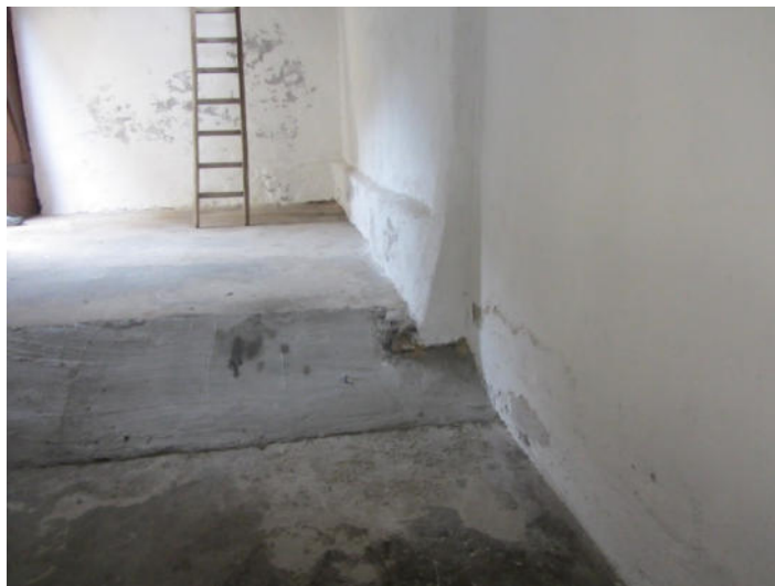
Bild 44: EG Nebengebäude, Garage/ Bodenunebenheit
