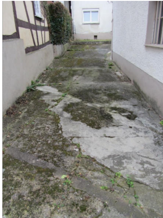
Bild 5: Mangelhafter Belag der Hoffläche
