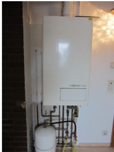
Bild 26: OG Wohngebäude, Zustand Gas-Etagenheizung im Flur
