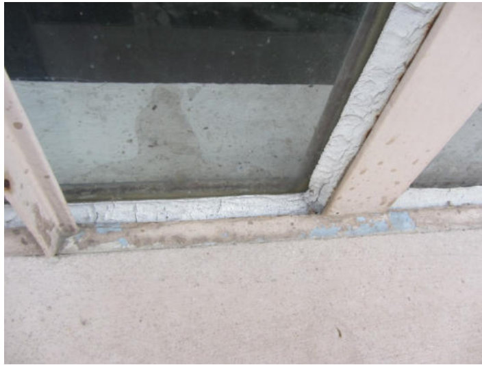
Bild 41: Nebengebäude, Zustand Fenster
