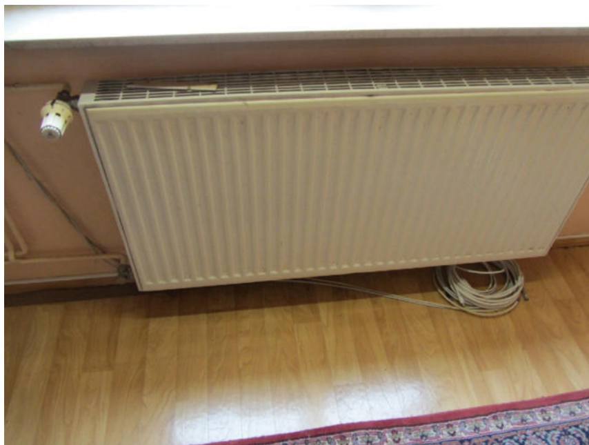
Bild 18: EG Wohngebäude, Zustand Heizkörper
