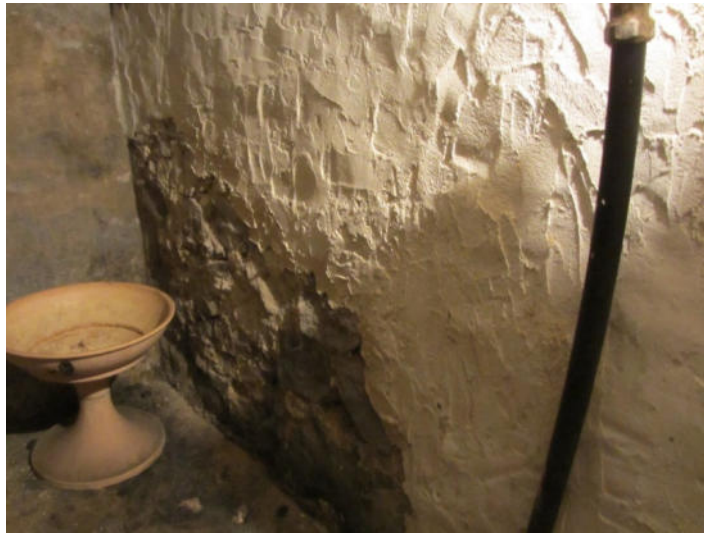
Bild 15: KG Wohngebäude, feuchte Kellerwand
