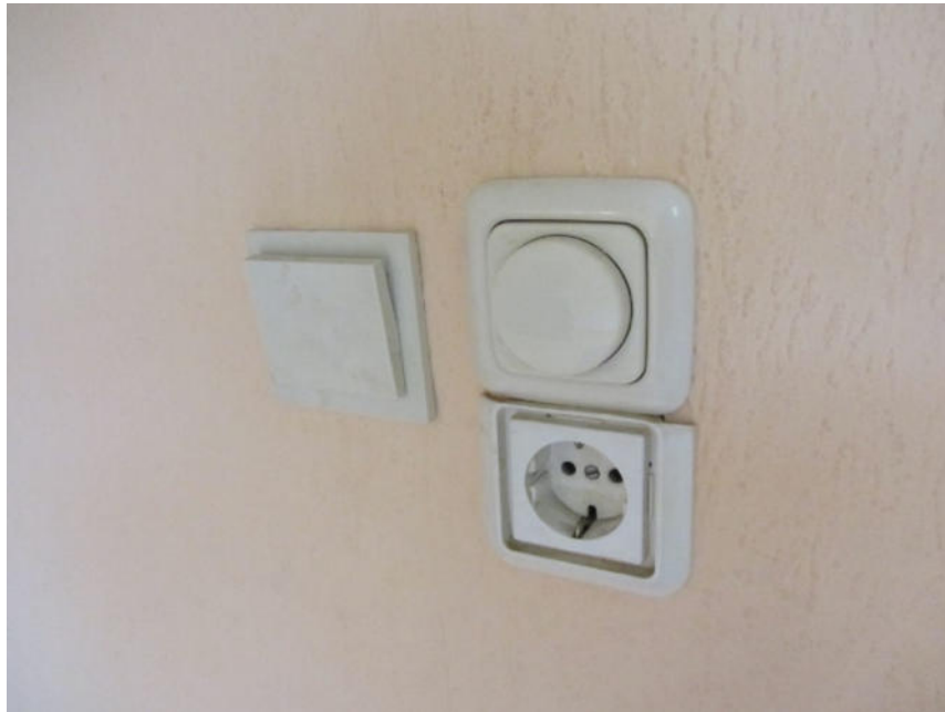
Bild 21: EG Wohngebäude, Zustand Elektro
