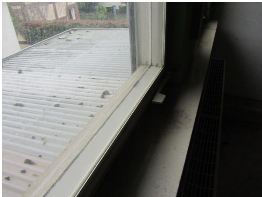
Bild 34: OG Wohngebäude, Zustand Fenster
