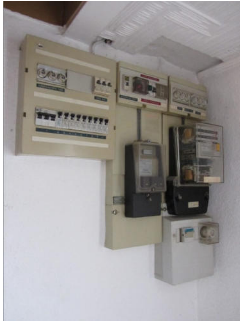
Bild 27: OG Wohngebäude, Zustand Elektrozähler
