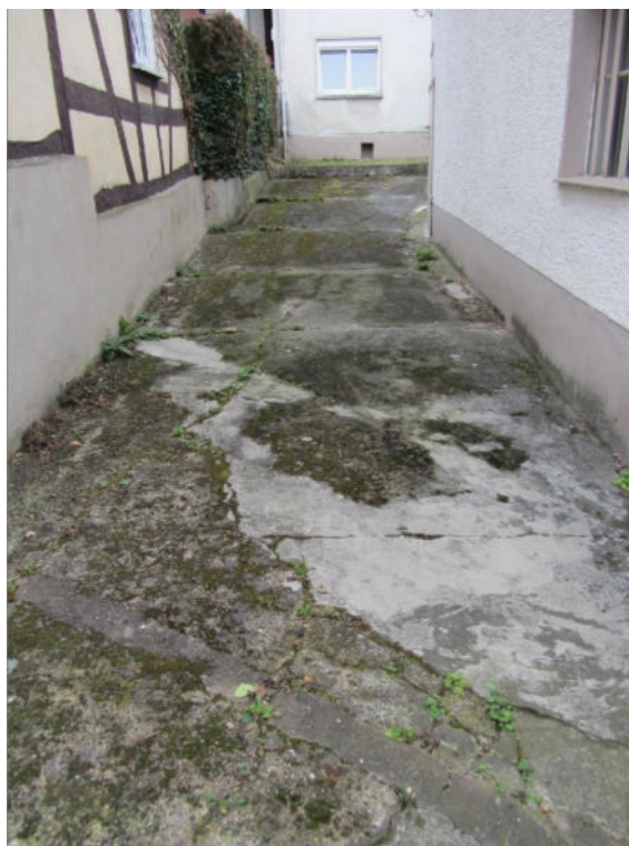
Bild 5: Mangelhafter Belag der Hoffläche
