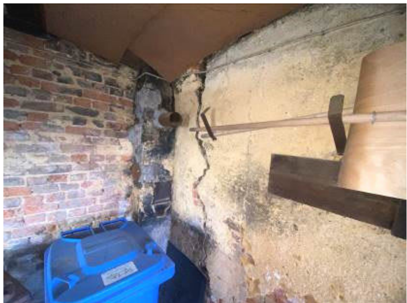
Abb. 10: Foto des SV; z.T. Risse im Mauerwerk (Lagerraum)
