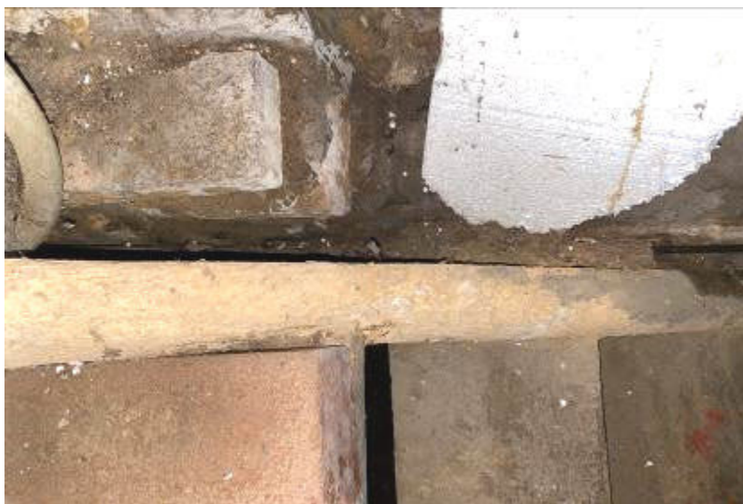
Abb. 5: Foto des SV; z.T. Holzterasse mit Schädlingsbefall (KG-EG)
