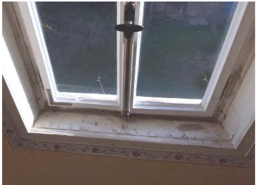
Abb. 7: Foto des SV; z.T. Holzfenster überaltert/schadhaft (OG)
