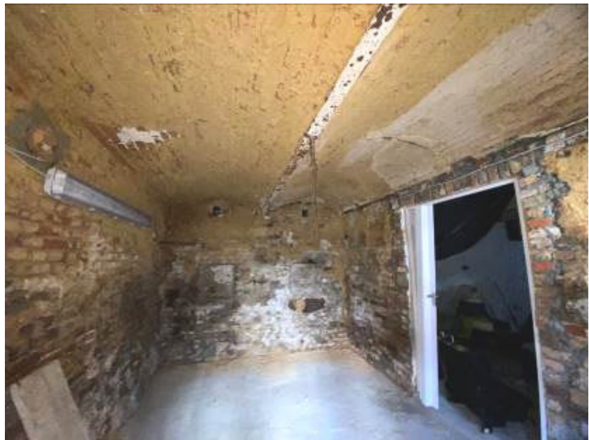
Abb. 11: Foto des SV; z.T. starke Salzausblühungen in unteren Wandbereichen (vermutl. d. Nitratbelastungen (Salpeter)) (Stall)
