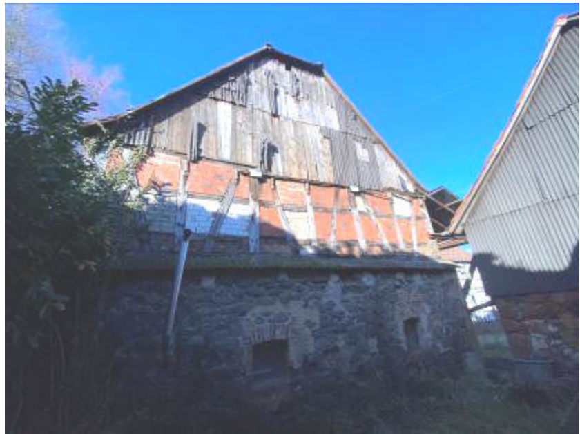
Abb. 9: Foto des SV; z.T. Giebel-Ausfachungen/Verkleidungen stark schadhaft (Scheune)
