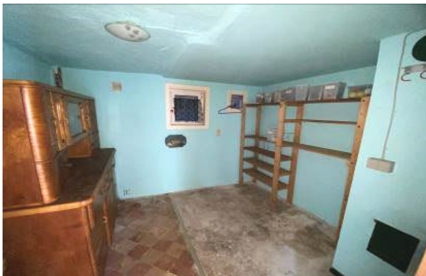
Abb. 4: Foto des SV; z.T. Raumboflächen überaltert/ schadhaft
