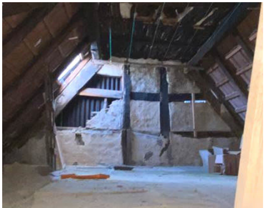
Abb. 8: Foto des SV; z.T. Ausfachungen schadhaft (DG)
