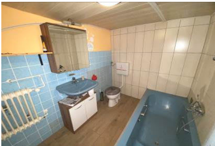
Abb. 6: Foto des SV; Bad/Sanitäre Objekte überaltert
