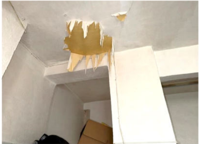
Abb. 3: Foto des SV; EG, Raumbooberflächen schadhaft/überaltert
