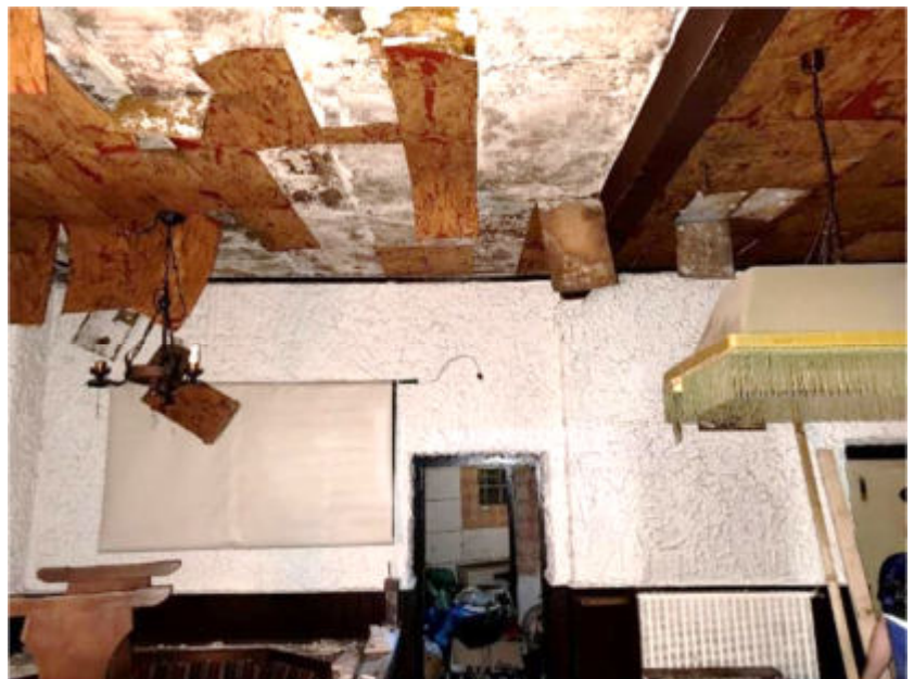
Abb. 4: Foto des SV; EG, Raumbooberflächen schadhaft/überaltert
