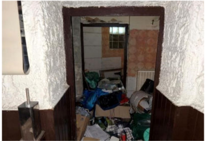
Abb. 5: Foto des SV; EG, Raumbooberflächen schadhafft/überaltert
