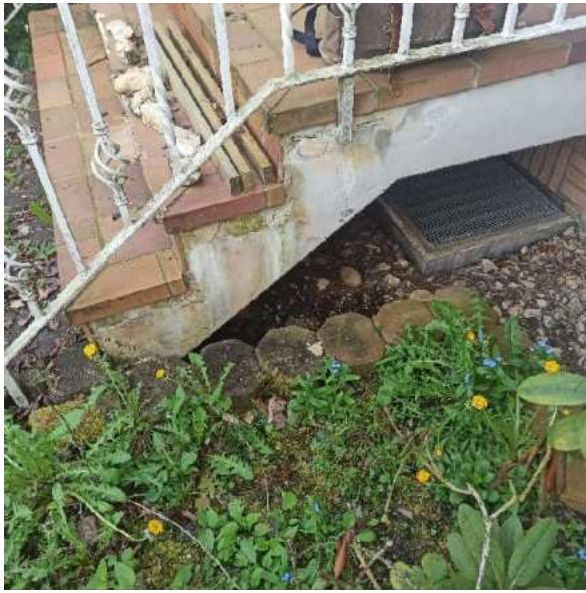
Wasserschaden an der Eingangstreppe in EG
