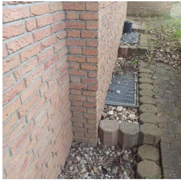
Klinkerfassade mit leichten Setzungsrissen
