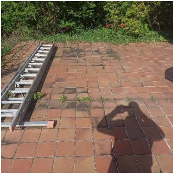
Wasserschäden an der Terrasse Erdgeschoss
