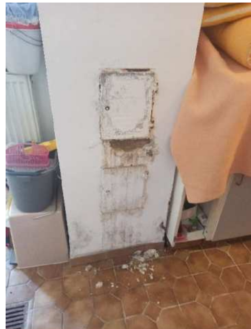
Wasserschaden am Kamin
