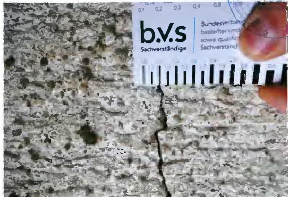
Bild 6: Setzungsrisse bis ca. 1,2 mm
