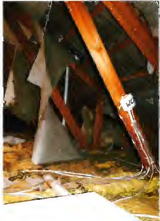
Bild 11: Spitzboden: WD nur aufgelegt, lückenhaft Unterspannbahn defekt
