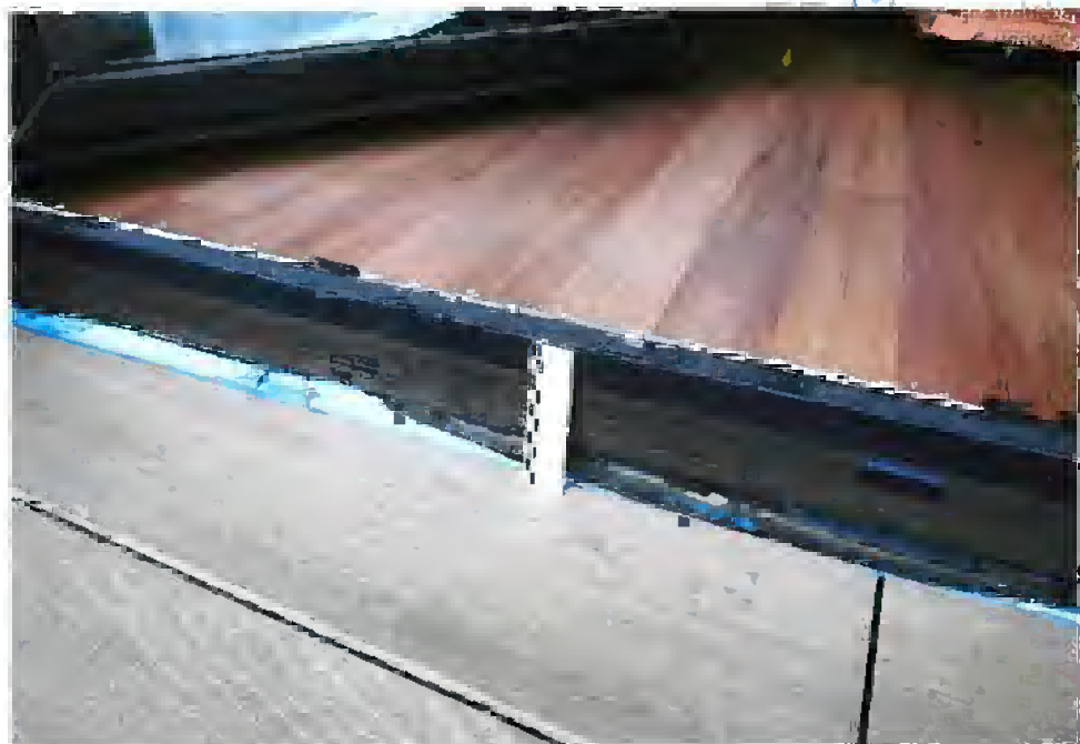
Bild 10: fehlende Einlaufrinnen an Balkonen, Sockelhöhe < 15 cm
