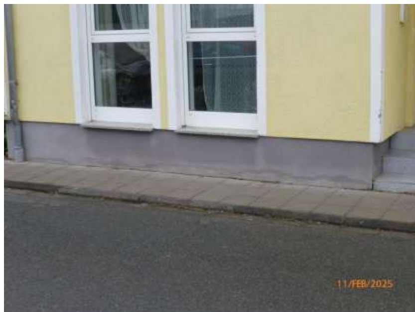
Feuchtigkeit im Sockel
