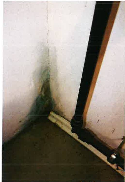
Bild 5: im Sockelbereich sind Verfärbungen erkennbar, Wirksamkeit der weißen Wanne zu überprüfen, ggf. zu verpressen
