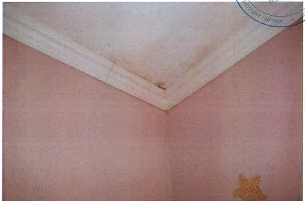
Bild 8: Stockfleckenbildung im Bereich des Schlafzimmers/Außenecke
