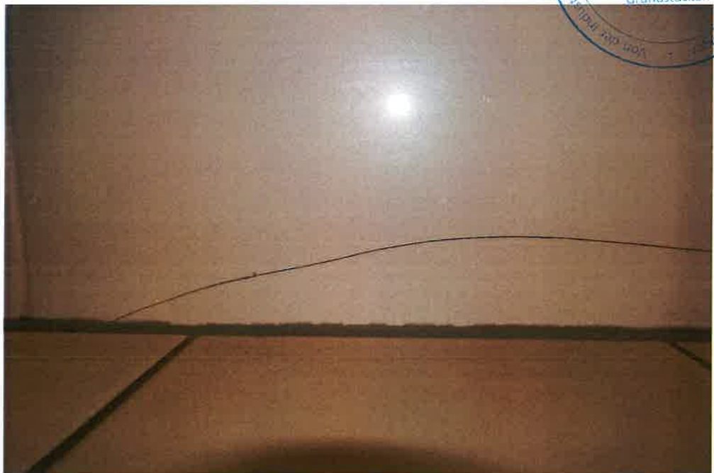
Bild 14: Risse im Bereich DuBad EG, im Bereich Sockel sind 3 Fliesen durchgerissen und hohlliegend
