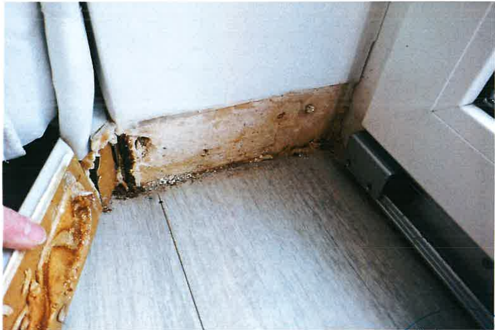
Bild 11: Sockel Wohnzimmer/Terrasse mit Feuchtigkeitsschaden, innen ist der Putz feucht die Putz-Eckschiene ist bereits stark korrodiert, mutmaßlich Sockelabdichtung mangelhaft; zudem ist die Sockelhöhe/Anschluss Terrassentür zu gering, kleiner als 15 cm, hier ist eine Entwässerungsrinne gem. DIN einzubauen
