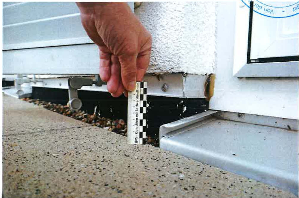
Bild 12: gleiches gilt für den Anschluß Balkon OG, auch hier der Anschluss zur Balkontür viel zu gering, deutlich geringer als 15 cm, Entwässerungsrinne dringend einzubauen, Notüberlauf des Balkons nicht erkennbar
