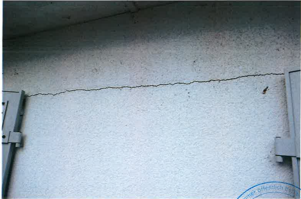
Bild 9: Riss im Außenputz vor allen Dingen im Sturzbereich OG/DG z. T. horizontal durchgehend, Rissbreite nach Süden zwischen den beiden Fenstern bis zu 2,5 mm! dringend statisch zu prüfen, Ursache ist festzustellen
