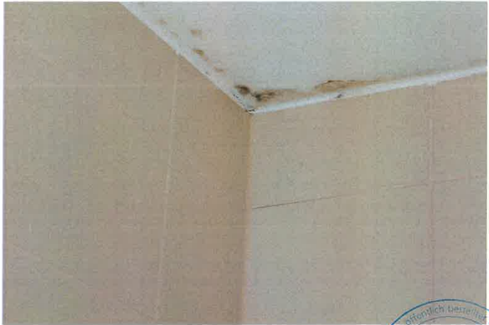
Bild 7: Stockfleckenbildung im Bereich des Bades/Außenecke
