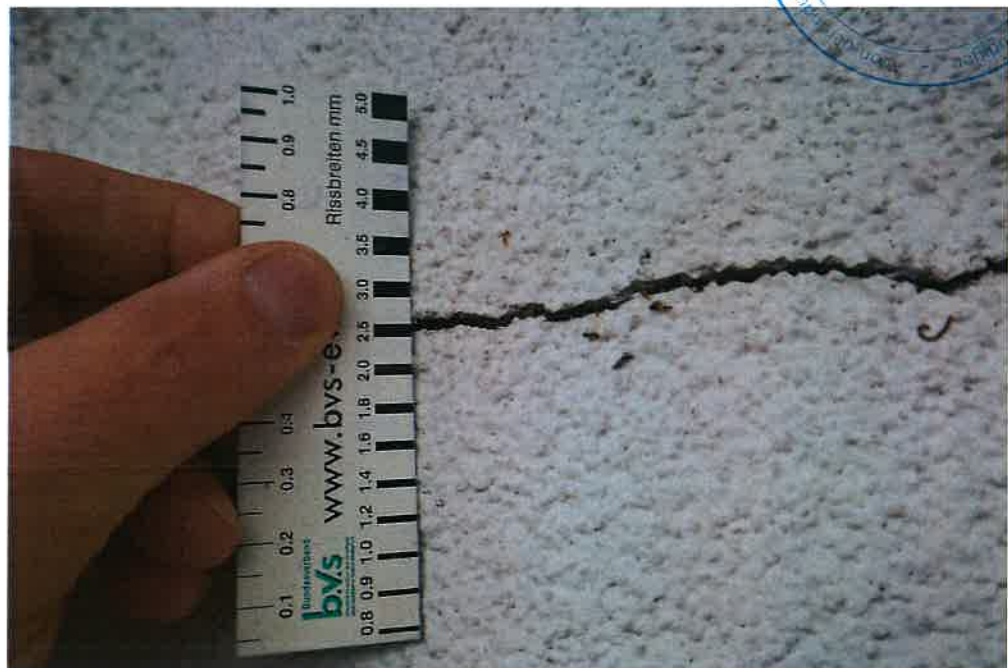
Bild 10: Riss im Außenputz vor allen Dingen im Sturzbereich OG/DG z. T. horizontal durchgehend, Rissbreite nach Süden zwischen den beiden Fenstern bis zu 2,5 mm! dringend statisch zu prüfen, Ursache festzustellen
