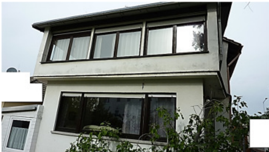
überstehender Anbau im OG mit Fassadenschäden
