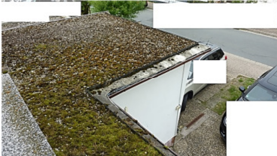
Eingangsvordach / Garagendach mit Abnutz.ersch. / Schadstellen
