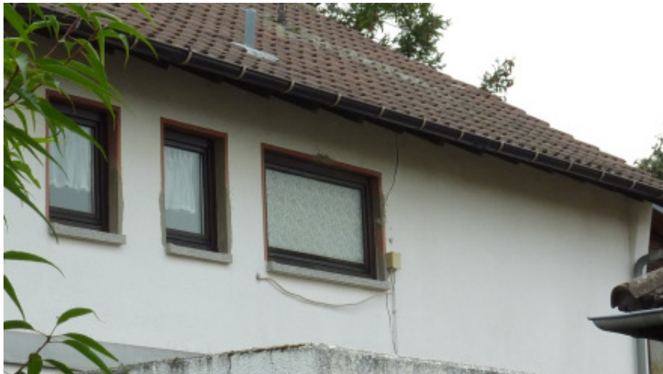
Setzriss in Seitenfassade rechts
