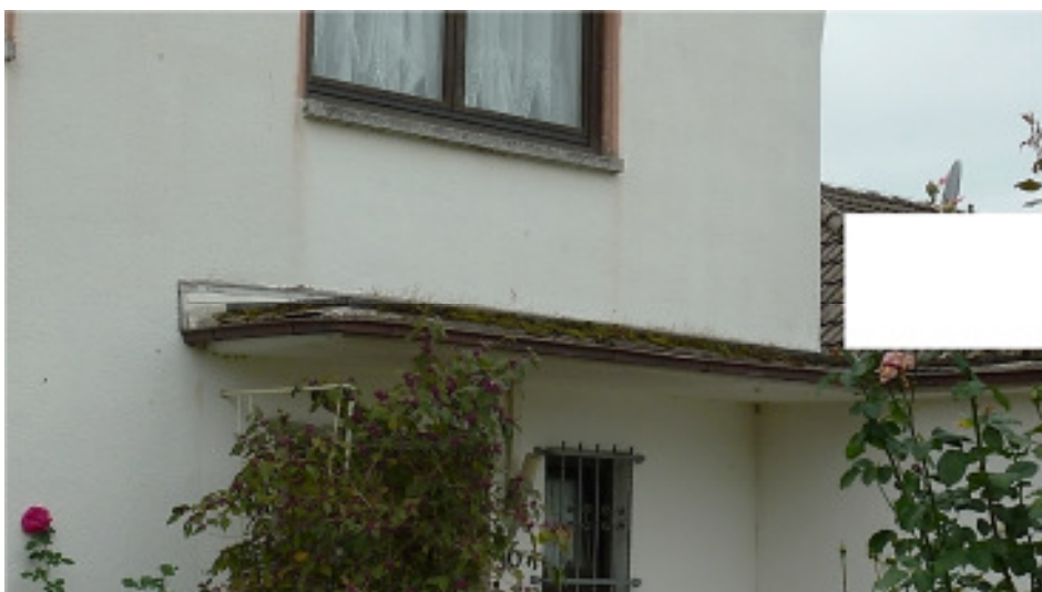
Eingangsvordach / anschließ. Garagendach mit Abnutz.ersch./Schadstellen
