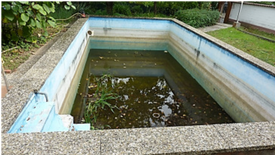
Schwimmbecken mit erhebl. Schadstellen
