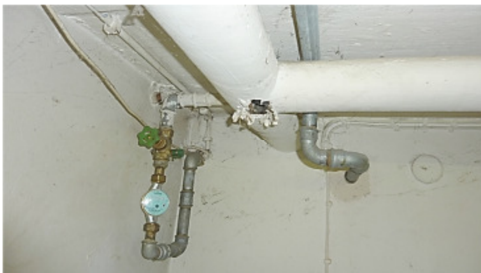
tlw. ältere Leitungen an Kellerdecke
