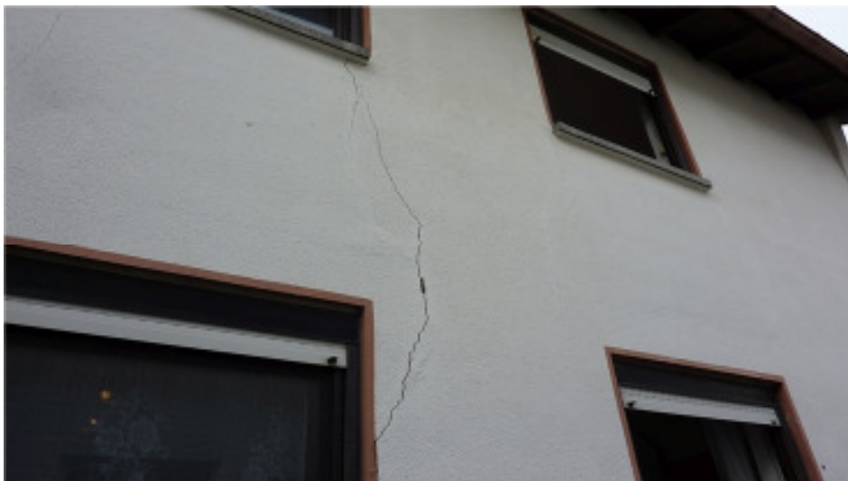
Setzriss in Seitenfassade links
