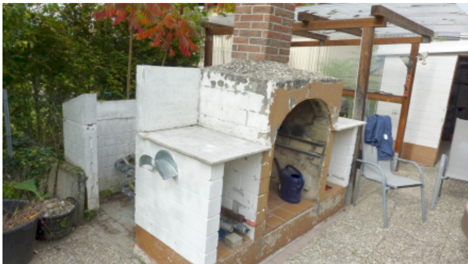
Grillstelle mit Schadstellen / Holzpergola
