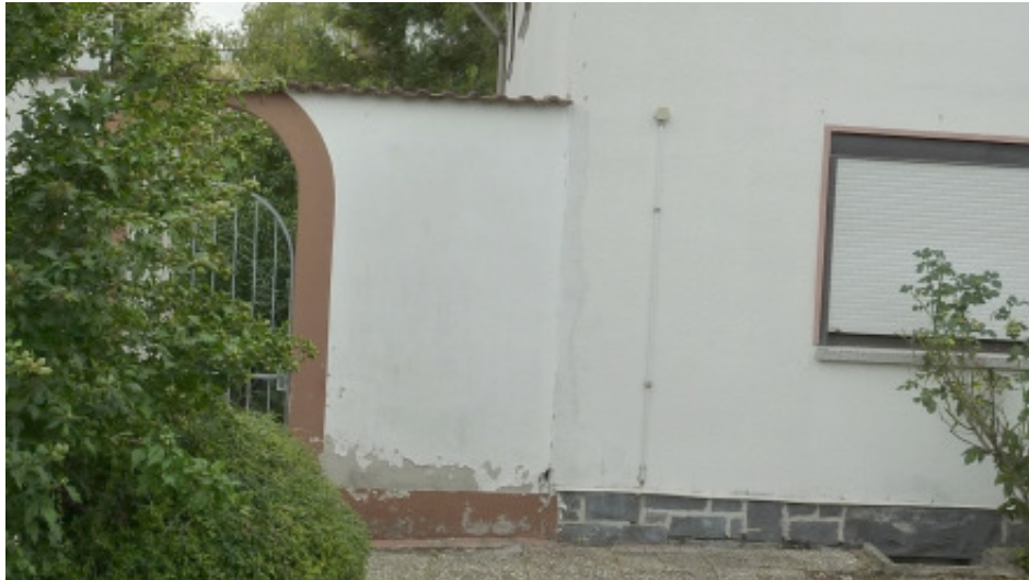
Fassade / Mauereinfriedung mit Abnutz.ersch. und Schadstellen
