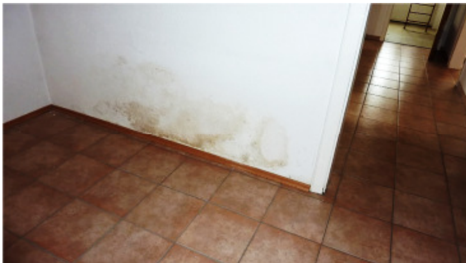
Feuchteschaden Rückwand Bad OG
