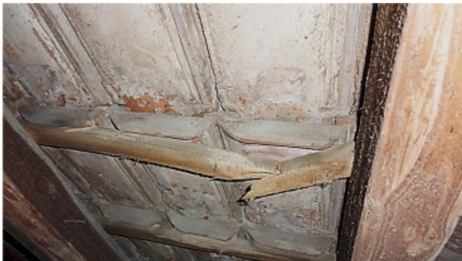
alte Dachziegel in Teilber. mit Abnutz.ersch. / Dachlatte gebrochen (partiell)
