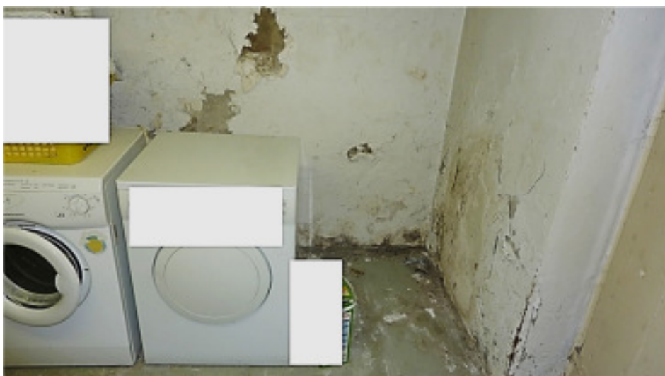
Feuchte-/Putzschäden im Kellersockel-/Kellerwandbereich
