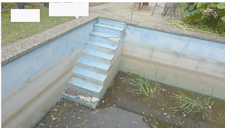
Schwimmbecken mit Schadstellen
