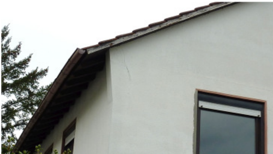
Fassade mit versch. Haar-Rissbildungen
