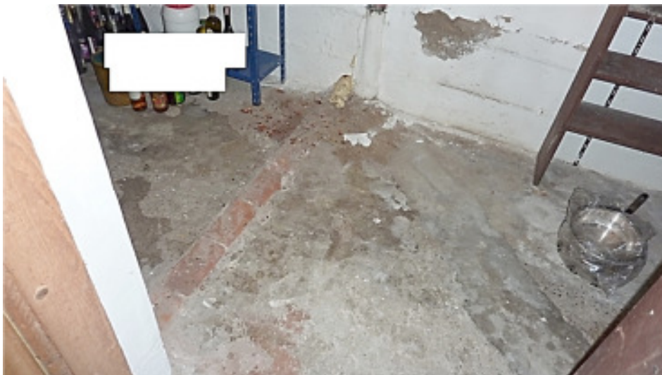
Feuchte-/Putzschäden Kellersockel / Kellerboden (partiell)
