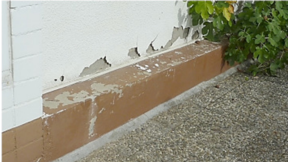
Schadstellen im Haussockelbereich
