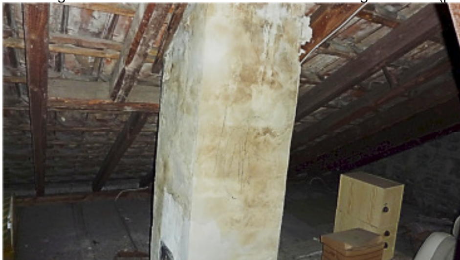
tlw. versotteter Schornstein im Speicher
