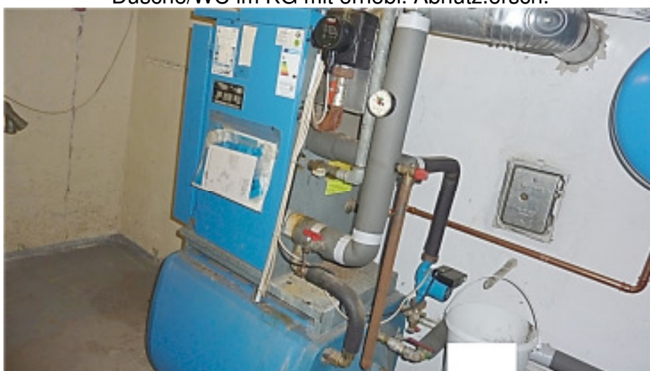
überalterter Heizkessel und überalterte Warmwasserbereitung im KG
