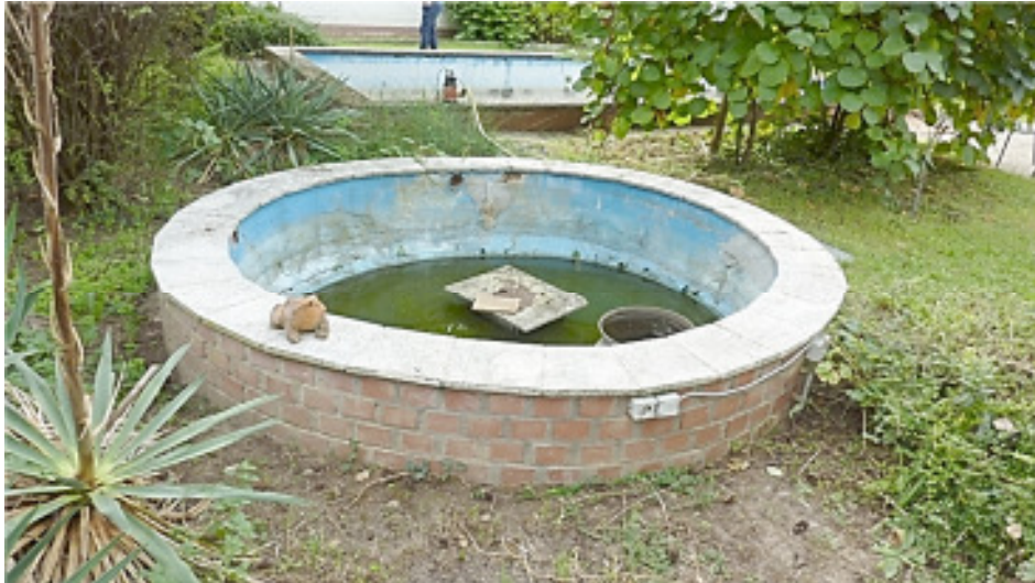
Teichbecken mit erhebl. Schadstellen
