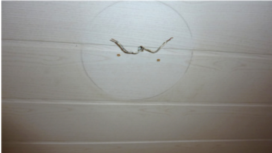
partiell nur 2-adrige Elektrokabel aus Deckenauslass
