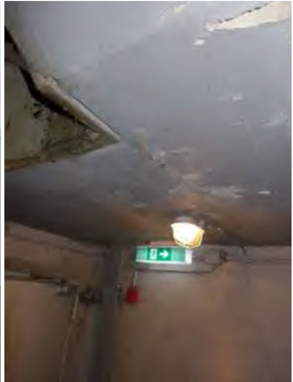
15 b Betonschäden Tiefgarage
