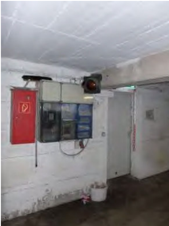
15 a Technik Tiefgarage
