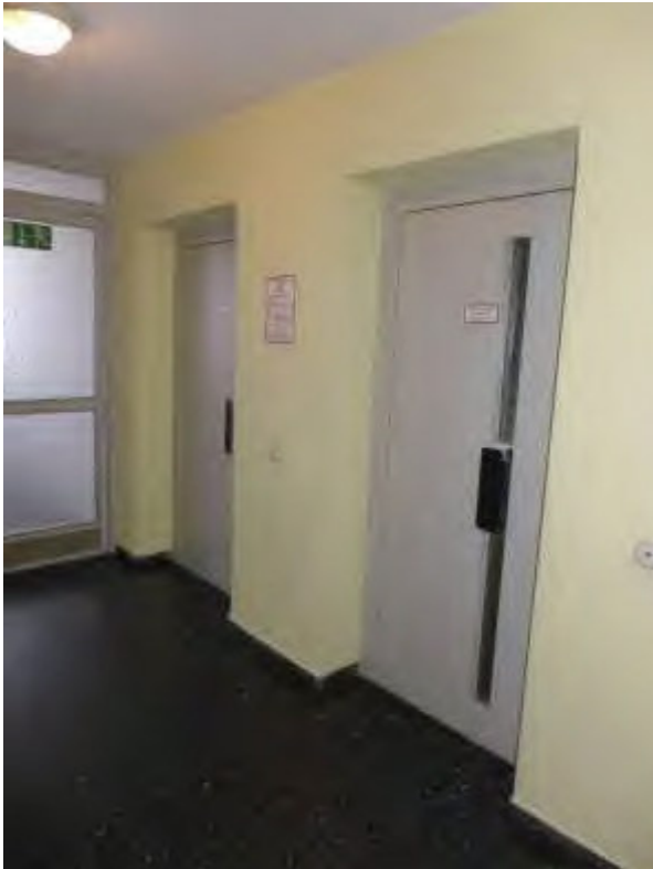
11 a Aufzugsanlage Haus 1
