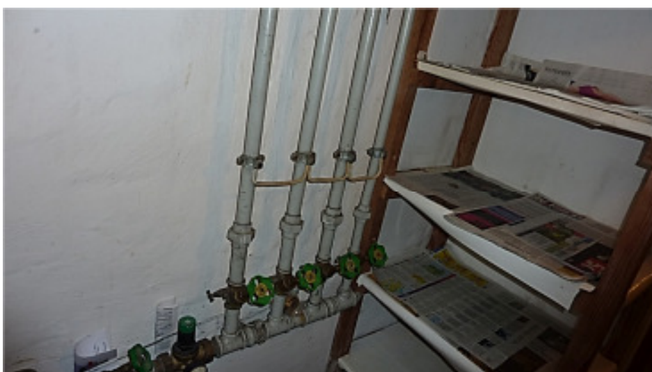
alte urspr. Wasserleitungen im KG
