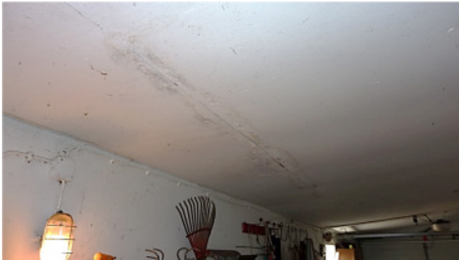
partielle Feuchteschäden an Garagendecke vom Dach her
