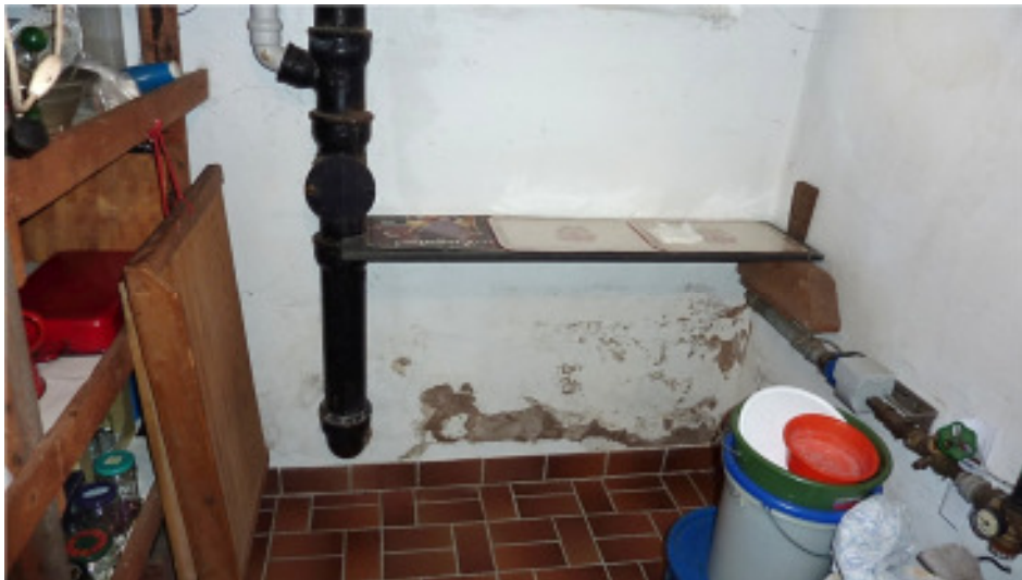
Feuchteschäden im Kellersockelbereich
