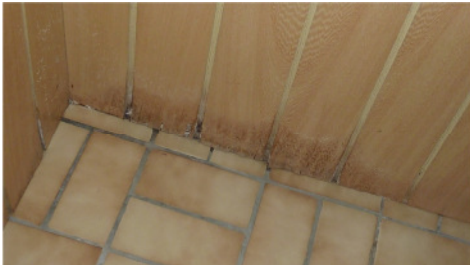
Feuchteschäden im KG-Sockel Holzverkleidung
