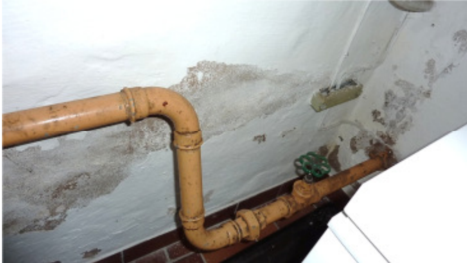
Feuchte-/Putzschäden im Kellersockelbereich
