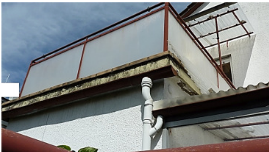
Balkon OG mit Schadst. im Bereich seidl. Kante
