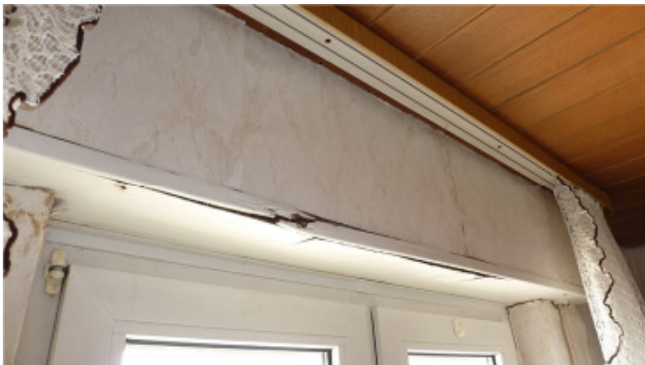
Wasserschaden Rollladenkasten Küche EG unter dem OG-Balkon
