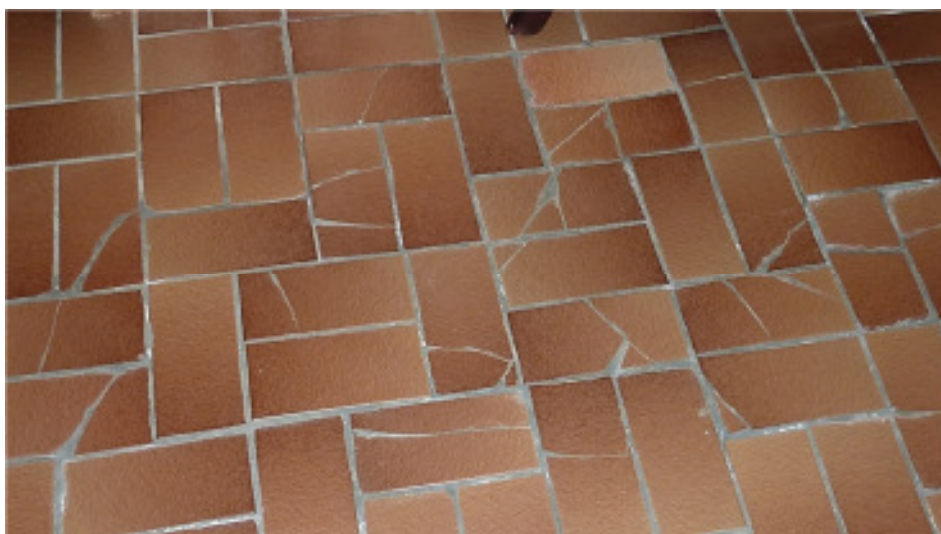
partielle Schadstellen Fliesen Kellerboden
