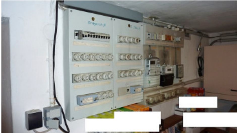
alter Elektrosicherungskasten / Verteilung im KG
