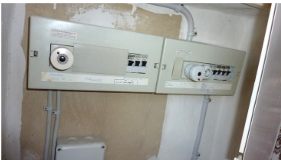
alte Elektroverteilung EG
