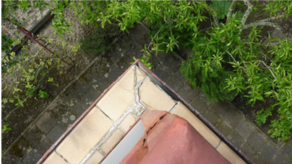
Balkon Randbereich mit Schadstellen
