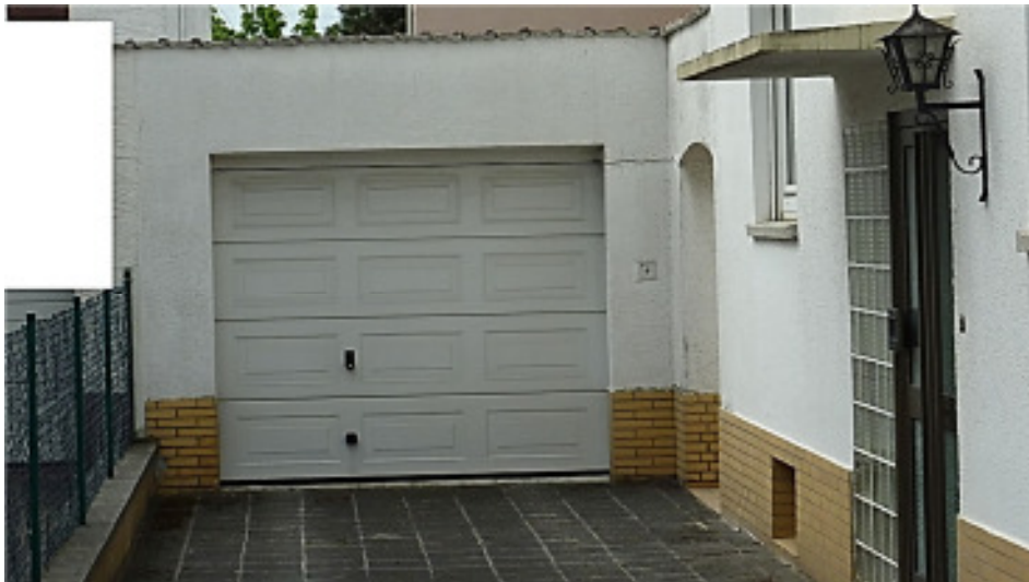
Garage und Rissbildung im Anschlussbereich
