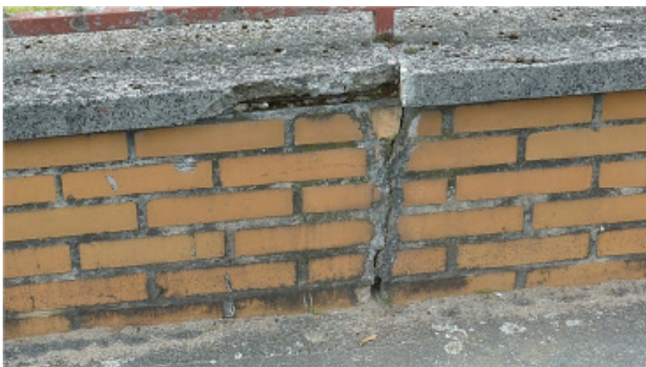
Einfriedungsmauer mit Schadstelle
