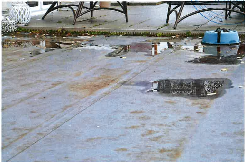
Bild 6: die Absturzsicherung der Terrasse zum Garten fehlt, der Belag ist nur im Bereich der Terrasse aufgebracht, ansonsten ist die Abdichtung der Tiefgaragendecke ohne Belag und ohne Schutz, z. T. geflickt
