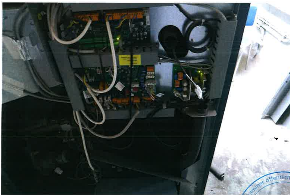
Bild 13: Pelletsheizung: Abdeckung Steuerungskasten fehlt, offensichtlich Störungsbeseitigung
