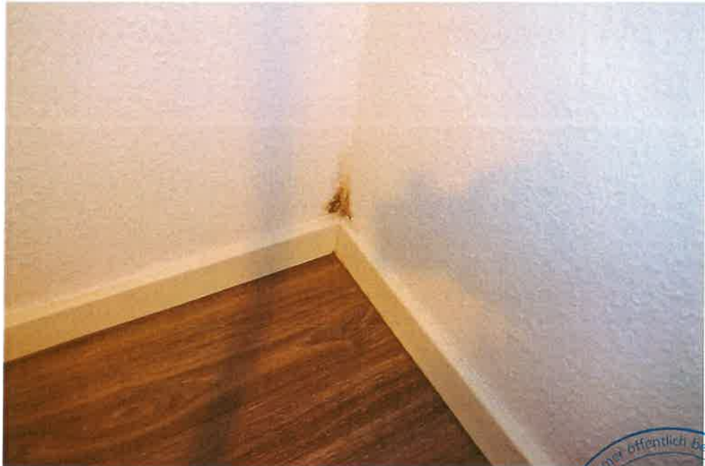
Bild 11: im Wohn-Esszimmer in der Südwestecke im Sockelbereich Stockfleckenbildung mit Feuchtigkeitsschaden, dieser würde immer auftreten, wenn es regnet, offensichtlich Undichtigkeit im Bereich des Anschlusses der Dachterrasse
