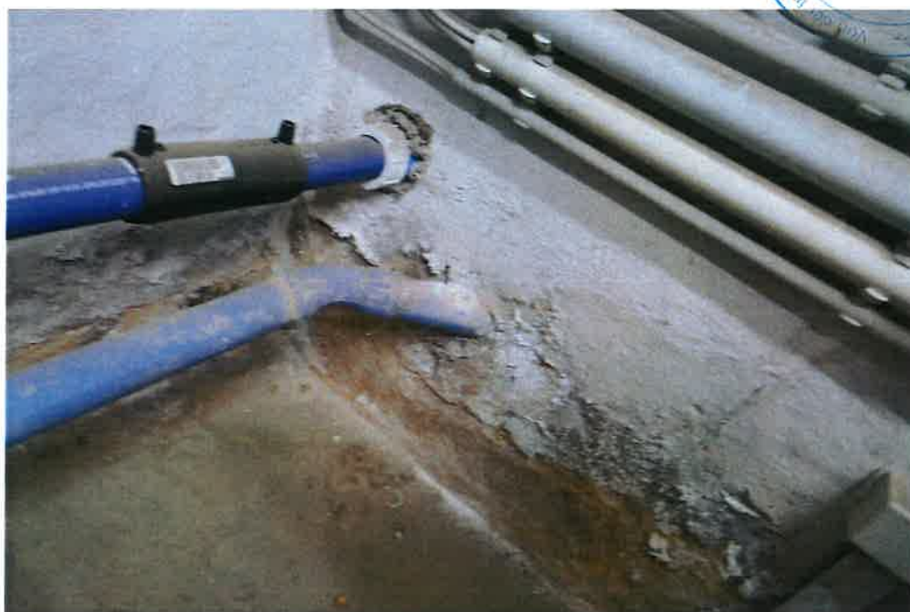
Bild 14: im KG Sockelbereich mit Putzschäden und Aussalungen der ursprünglichen Bauzeit ca. der 60er Jahre entsprechend
