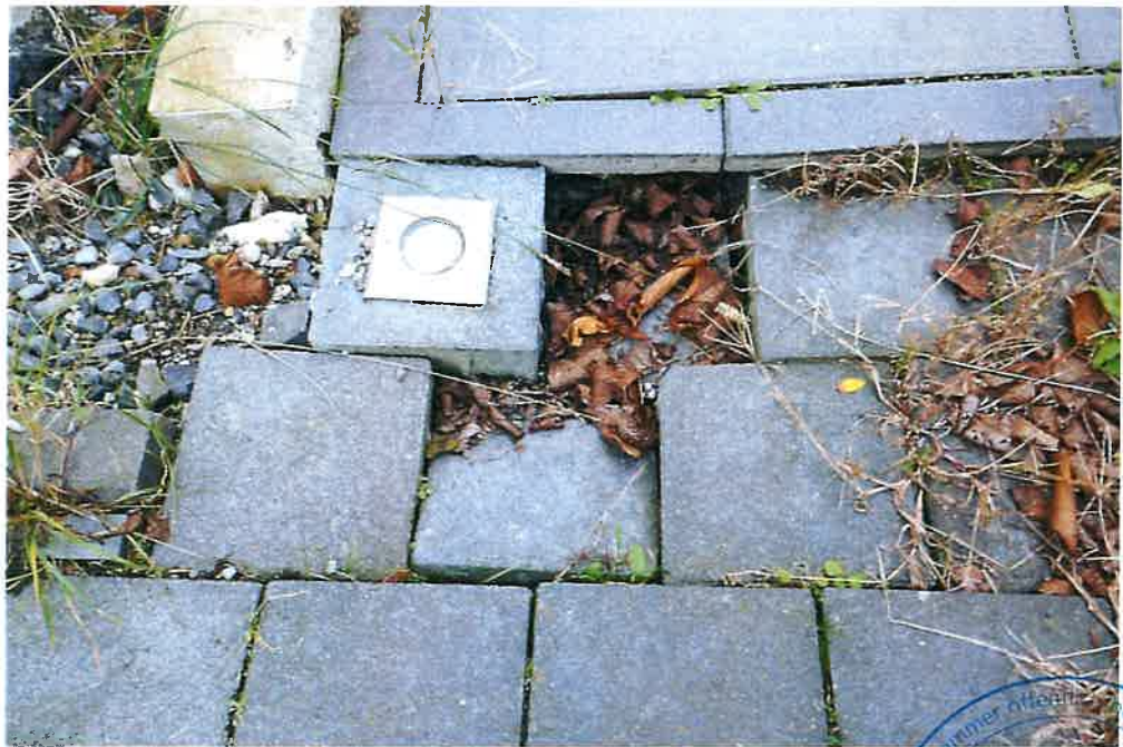
Bild 9: seitlich zum Haus: Rampe Beton mit Betonplattenbelag, am Antritt der Rampe hat sich das Pflaster gesenkt, ca. 15 cm (Stolpergefahr), dringend zu egalisieren, im Bereich des Briefkastens ist auch das Pflaster gesenkt, hier ebenfalls Stolpergefahr
