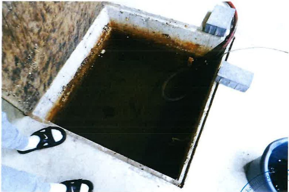
Bild 15: im hinteren Bereich der Tiefgarage: ein Schacht, welcher provisorisch mit einer Holzplatte bedeckt ist, in diesem steht Wasser und eine Tauchpumpe, welche das mutmaßlich das Wasser abpumpen soll, Herkunft des Wassers unklar
