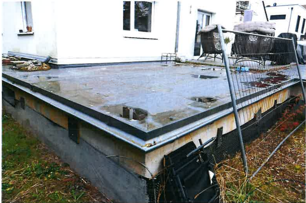
Bild 5: die Absturzsicherung der Terrasse zum Garten fehlt, der Belag ist nur im Bereich der Terrasse aufgebracht, ansonsten ist die Abdichtung der Tiefgaragendecke ohne Belag und ohne Schutz, z. T. geflickt
