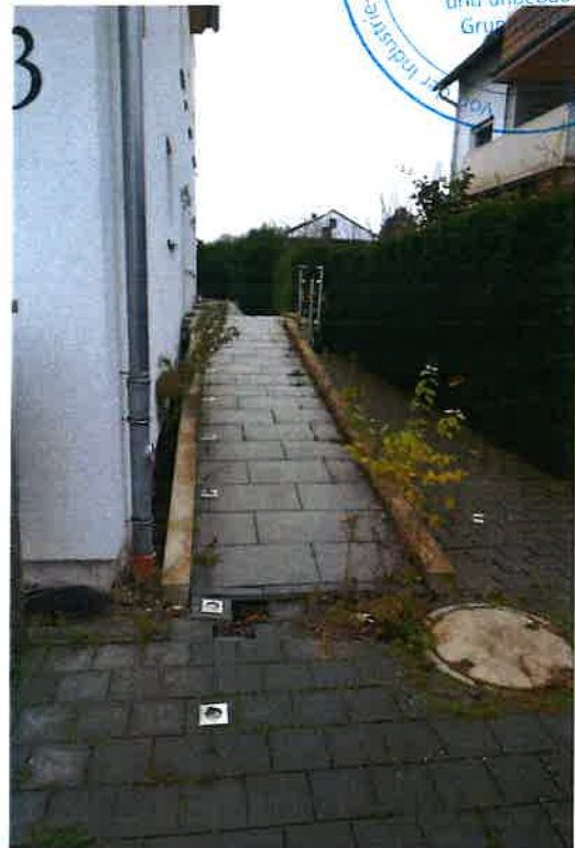
Bild 8: seitlich zum Haus: Rampe Beton mit Betonplattenbelag, am Antritt der Rampe hat sich das Pflaster gesenkt, ca. 15 cm (Stolpergefahr), dringend zu egalisieren, im Bereich des Briefkastens ist auch das Pflaster gesenkt, hier ebenfalls Stolpergefahr
