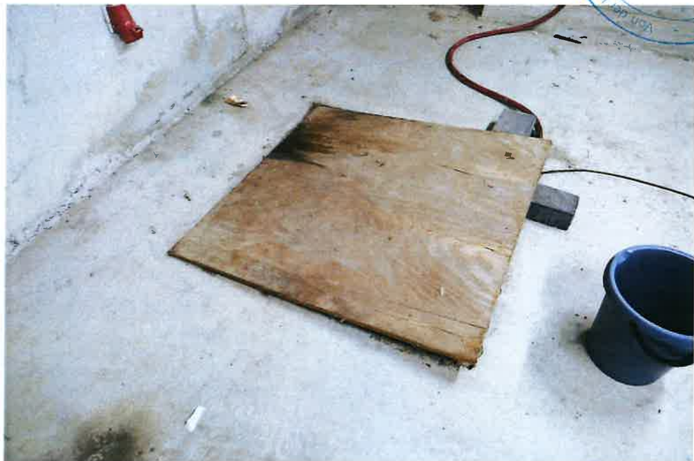
Bild 16: im hinteren Bereich der Tiefgarage: ein Schacht, welcher provisorisch mit einer Holzplatte bedeckt ist, in diesem steht Wasser und eine Tauchpumpe, welche das mutmaßlich das Wasser abpumpen soll, Herkunft des Wassers unklar
