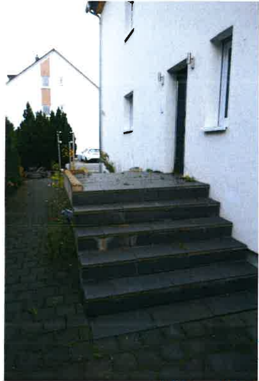
Bild 19: Geländer an der Rampe und Außentreppe fehlt, Absturzgefahr! dringend, zumindest provisorisch, zu sichern
