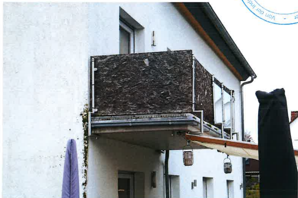
Bild 18: Balkon im 1. OG ist nicht nutzbar, da Absturzsicherung mangelhaft (OSB-Platte) nur provisorisch befestigt
