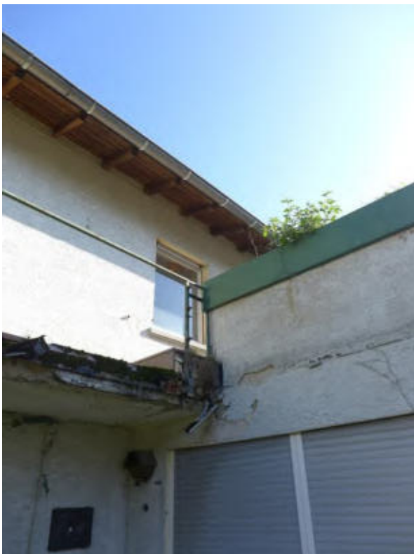
18 a schadhafter Balkon
