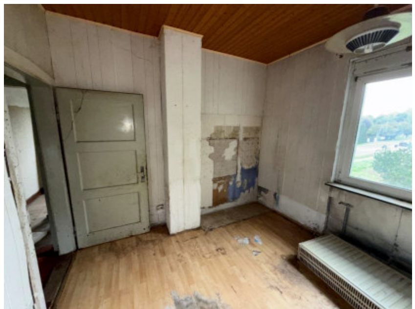
Abb. 4: Foto des SV; Raumbooberflächen überaltert/schadhaft, Heizkörper schadhaft und demontiert (Küche OG)
