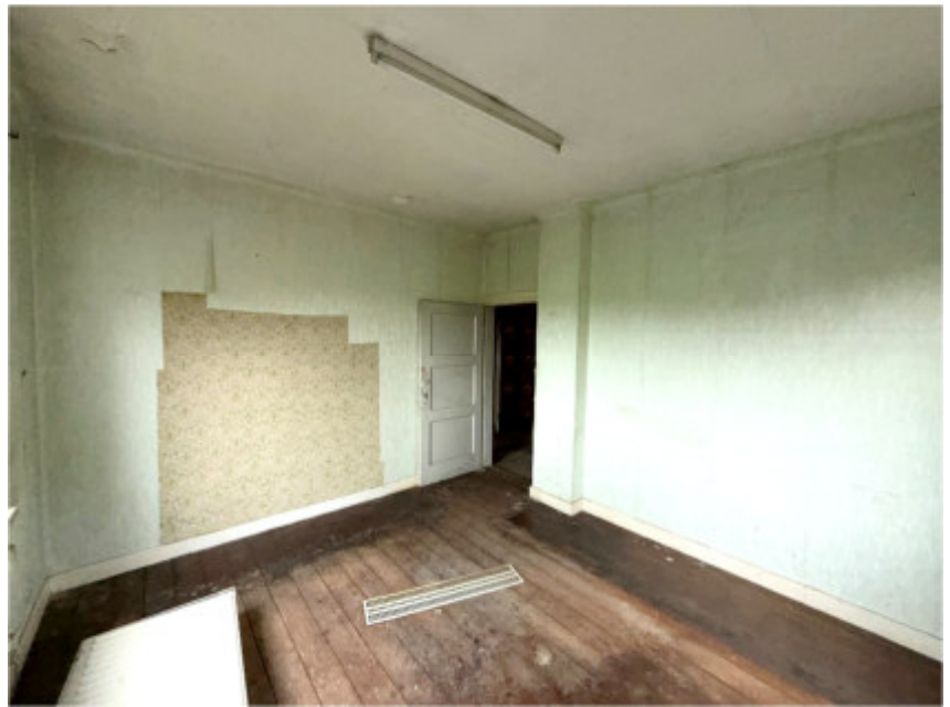
Abb. 3: Foto des SV; Raumbooberflächen überaltert/schadhaft, Heizkörper schadhaft und demontiert (Zimmer OG)
