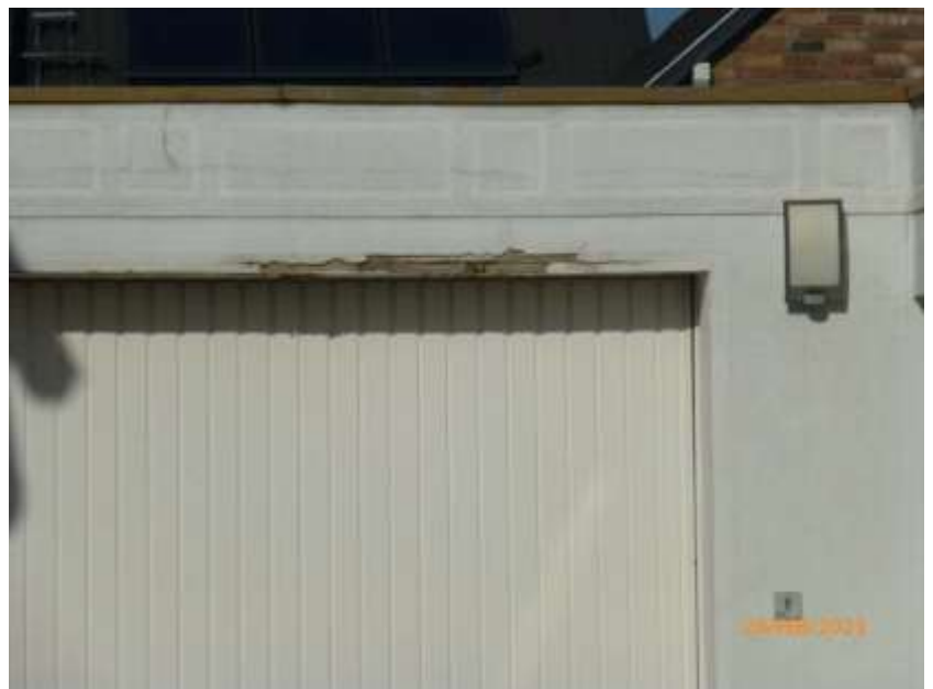
Garage mit Fassadenmängeln
