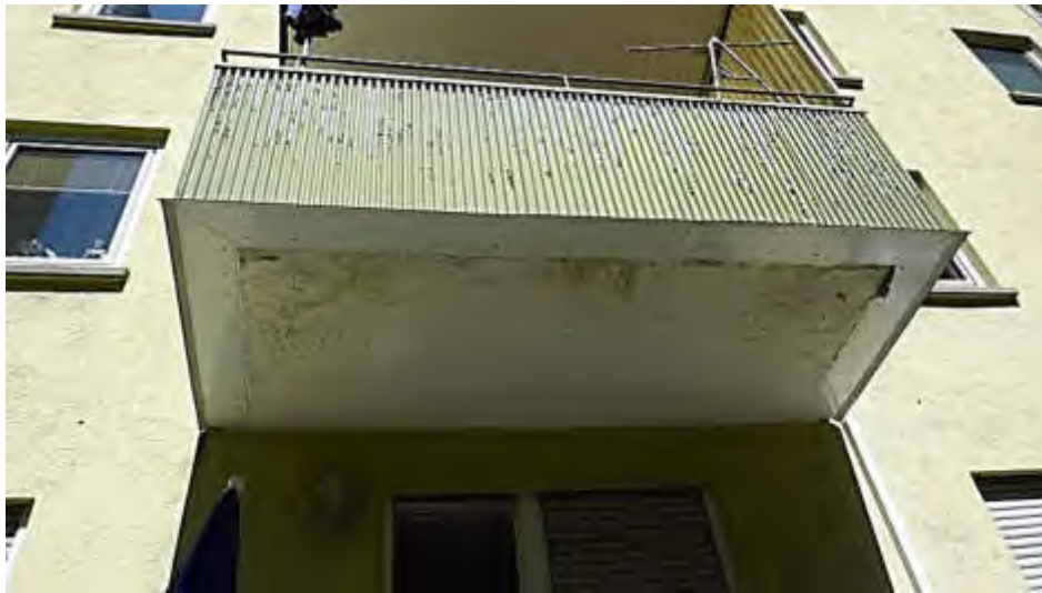
Balkonuntersicht mit Schadstellen
