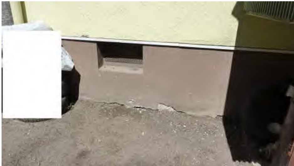
partieller Haussockelbereich mit Putzschäden
