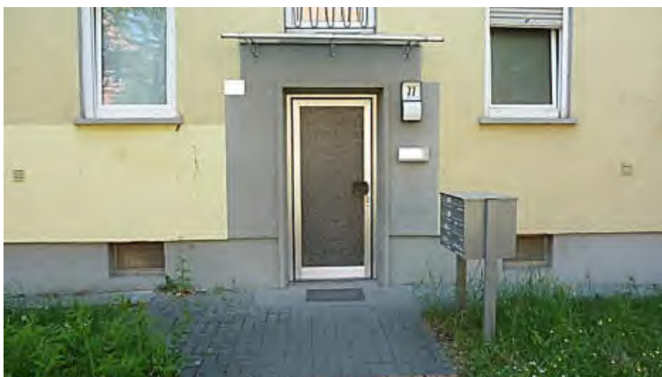
Hauseingangsbereich Rhönring 77 / Putzschäden Fassade links vom Eingang
