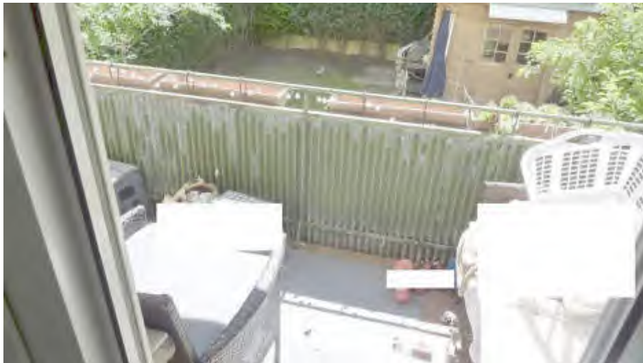
Balkongeländer mit Abnutz.ersch.
