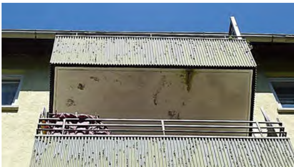
Balkonuntersicht mit Schadstellen
