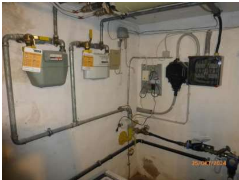
Innenansicht Kellergeschoss, Gaszähler für WEG 1 und WEG 2
