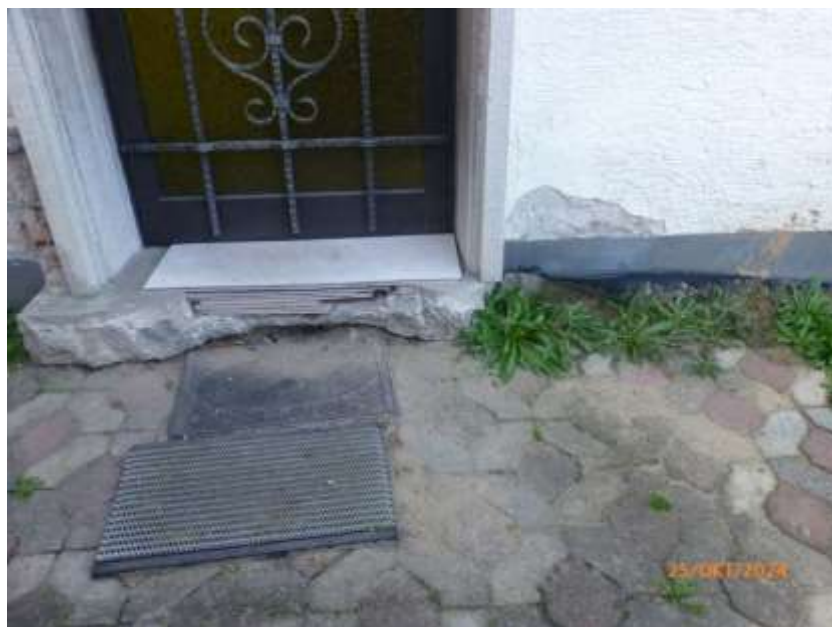
Hauseingang schadhafte Schwelle
