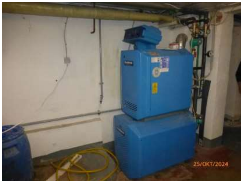
Innenansicht Kellergeschoss, Zentralheizung
