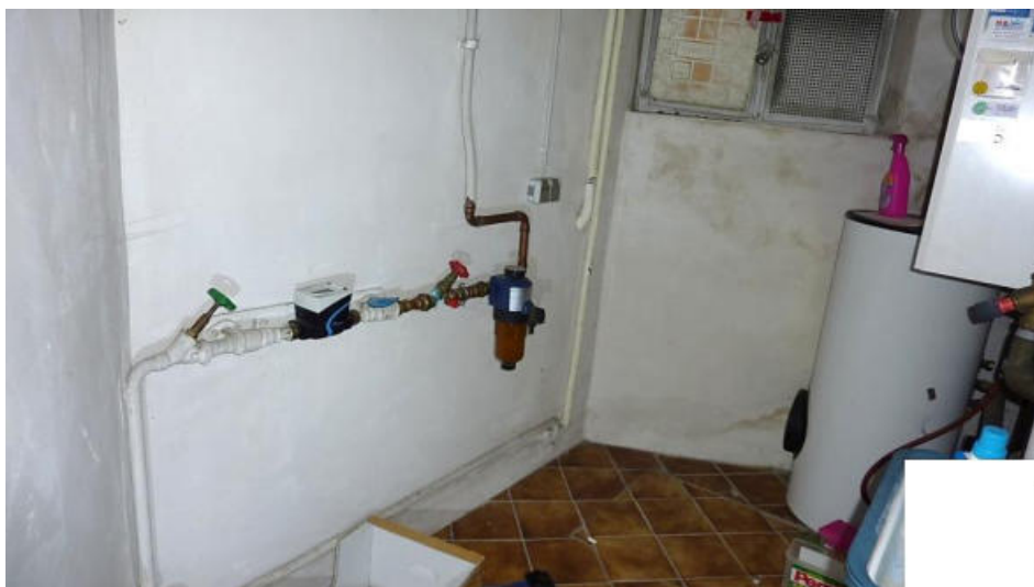
Heizraum KG mit tlw. Feuchteschäden
