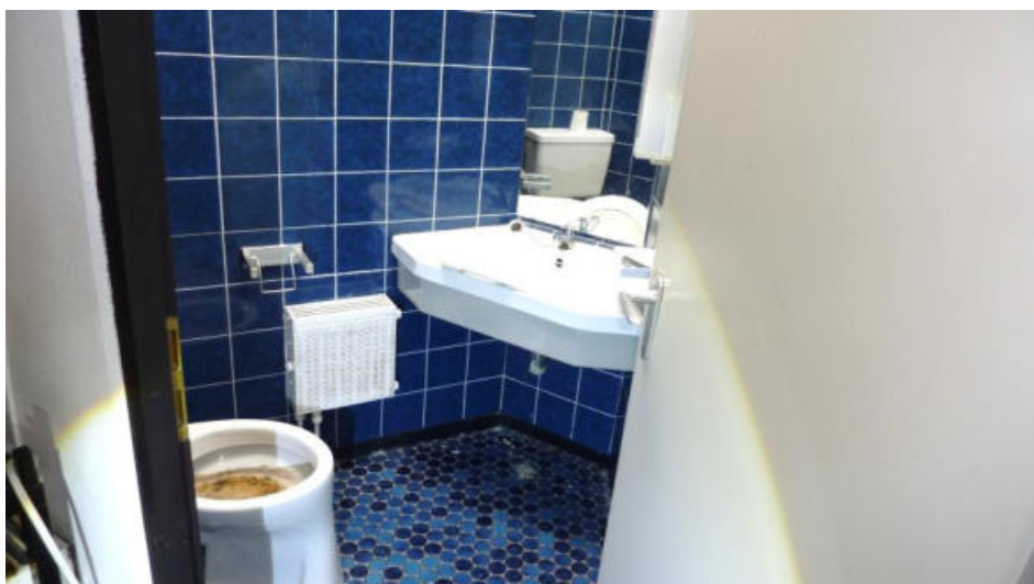
WC mit altersbed. Abnutz.ersch.
