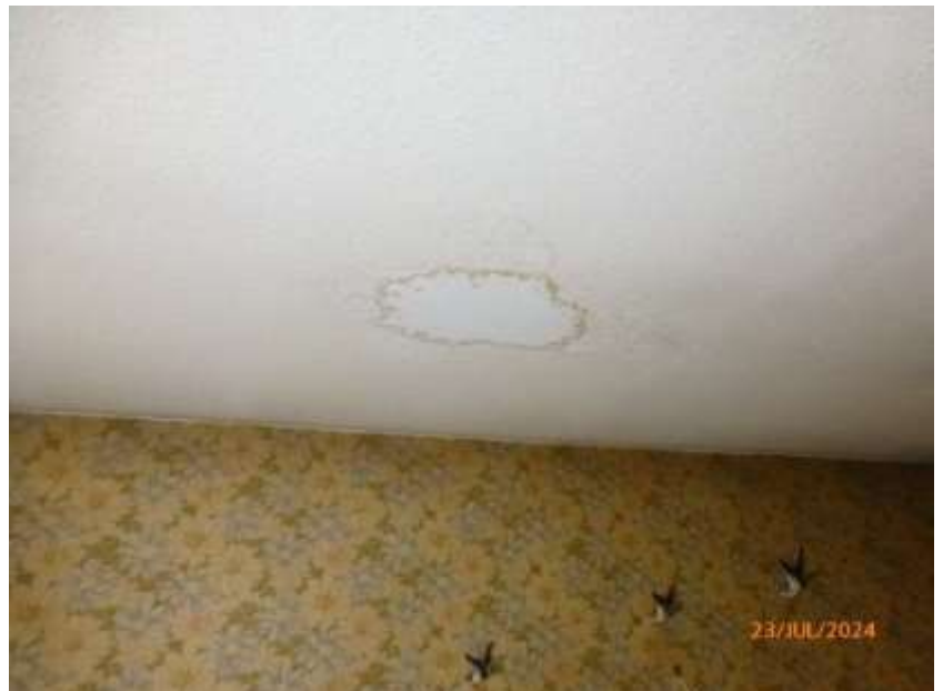
Innenansicht Dachgeschoss, Wasserschaden
