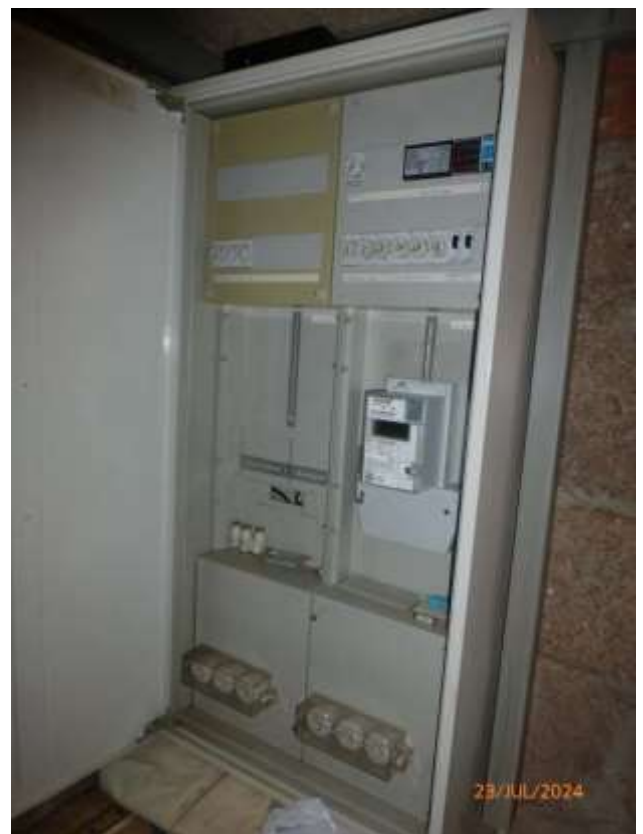
Innenansicht Erdgeschoss, Elektroinstallation
