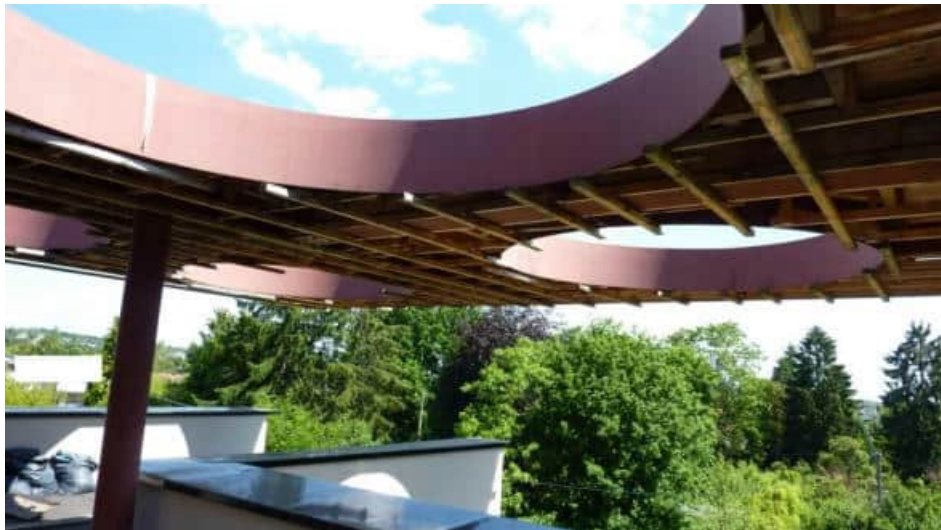
Dachterrassen-Überdachung mit Fertigstell.arb. (Teilbereich Rückbau erforderlich)
