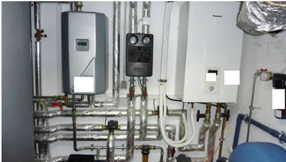
Technikraum im KG
