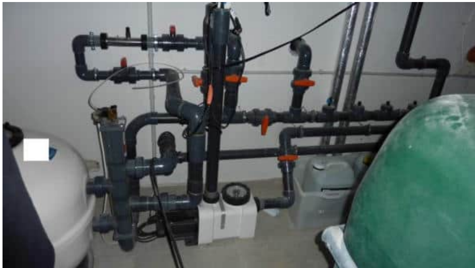
Technikraum im KG für Freischwimmbad
