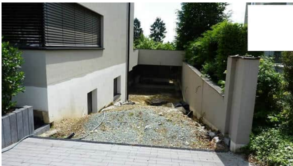
Rampe zu den Garagenplätzen mit Fertigstell.arb. / Mauerabdeckungen fehlen
