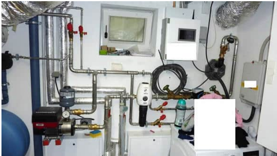
Technikraum im KG
