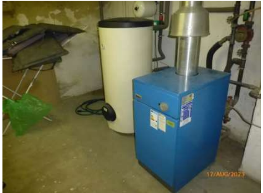
Zentralheizung im Keller
