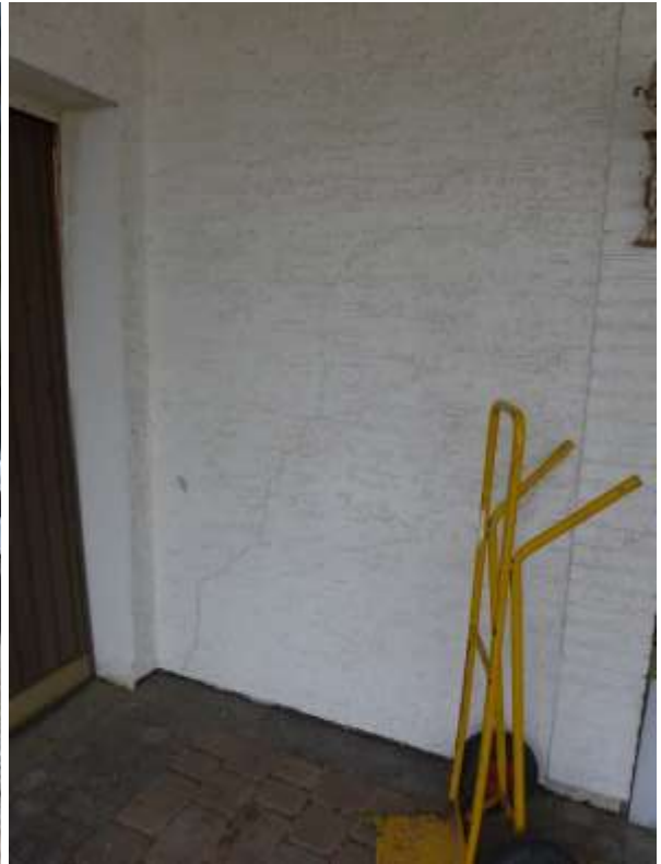
29 b Riss im Eingangsbereich
