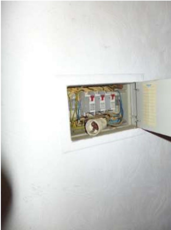
25 a Sicherungskasten Erdgeschoss
