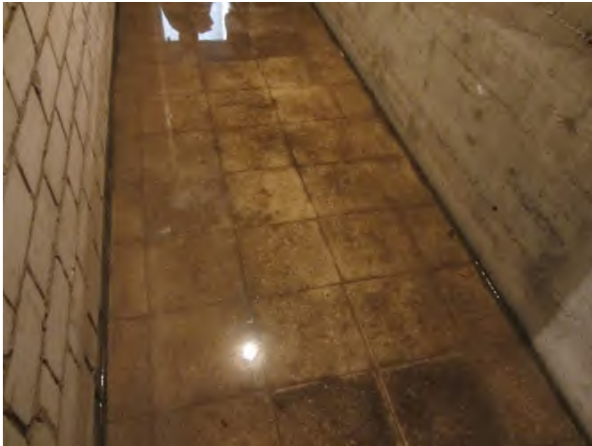
Bild 43: stehendes Wasser im Flurbereich des Kellers
