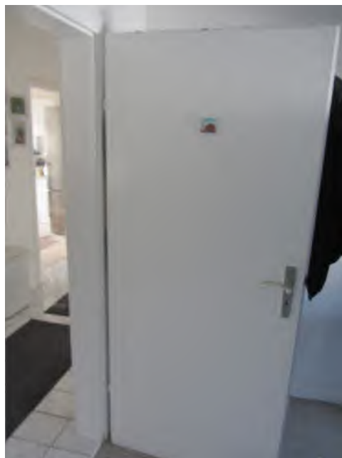
Bild 28: Wohnung 2.OG: Zustand Innentüren
