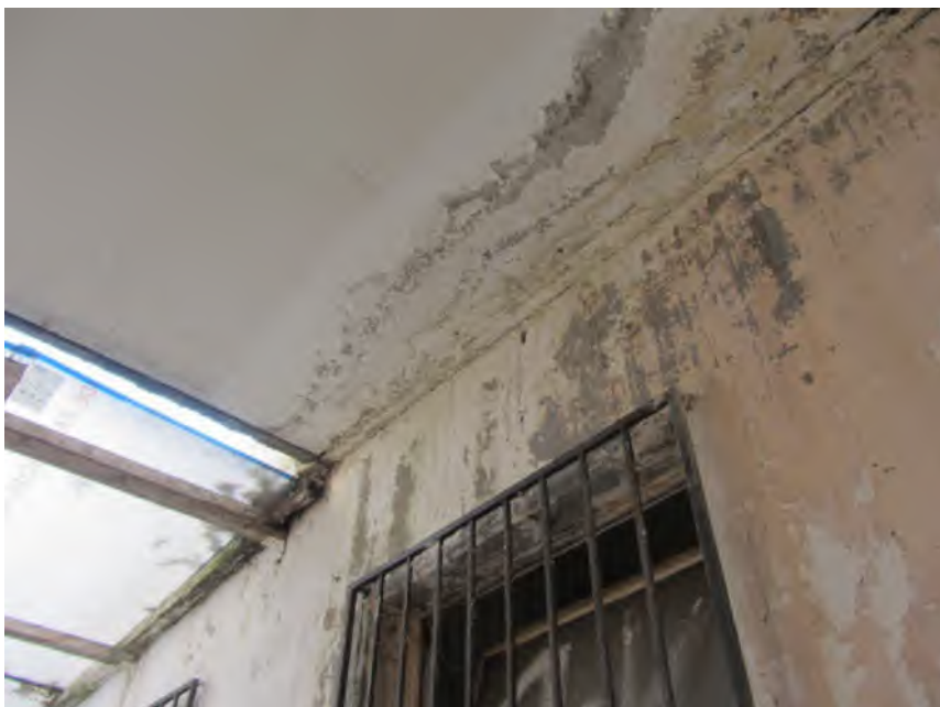
Bild 46: Dachleckage im Durchgangsbereich zu Treppenhaus
