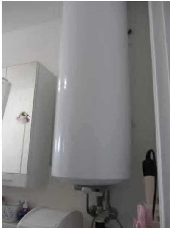
Bild 35: Wohnung 2.OG: elektrischer Warmwasser-Boiler
