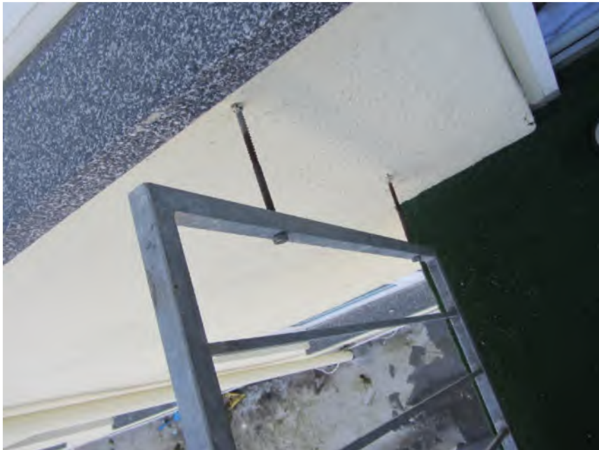
Bild 41: Wohnung 2.OG: Balkongeländer Befestigung unzureichend
