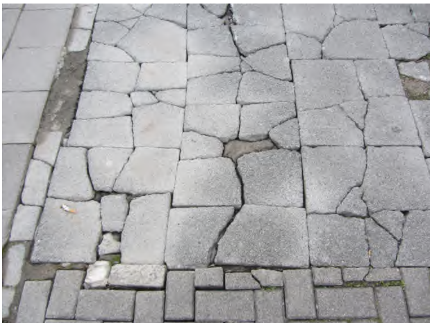
Bild 16: defekter Bodenbelag vor Gewerbeeinheit 04- Kebab-Restaurant
