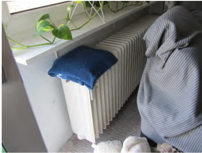
Bild 29: Wohnung 2.OG: Zustand Heizkörper
