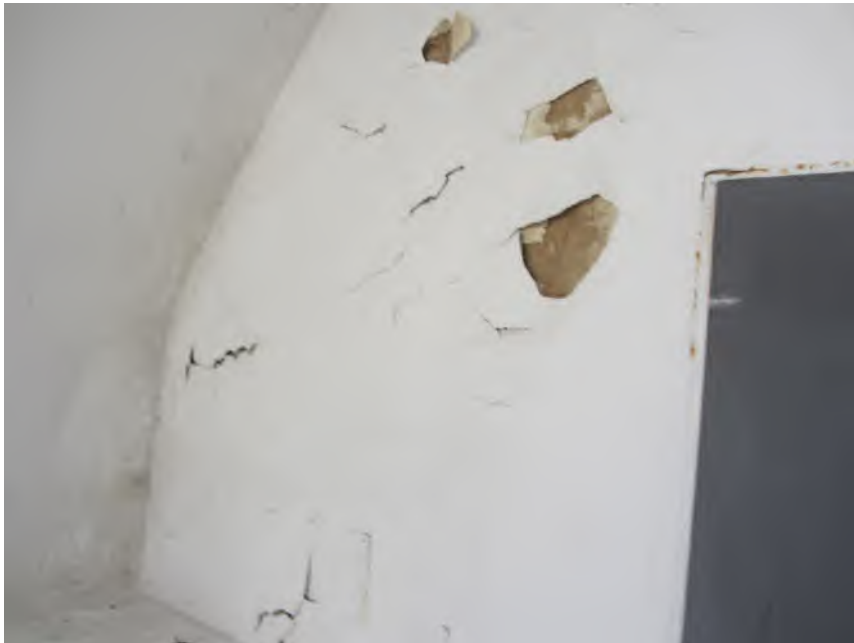
Bild 23: Putzschäden außenliegendes Treppenhaus
