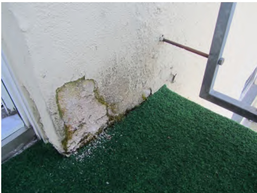
Bild 40: Wohnung 2.OG: Putzschaden Eckbereich Balkon
