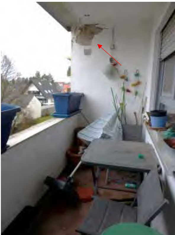
12 a Loggia, schadhafte Fassade
